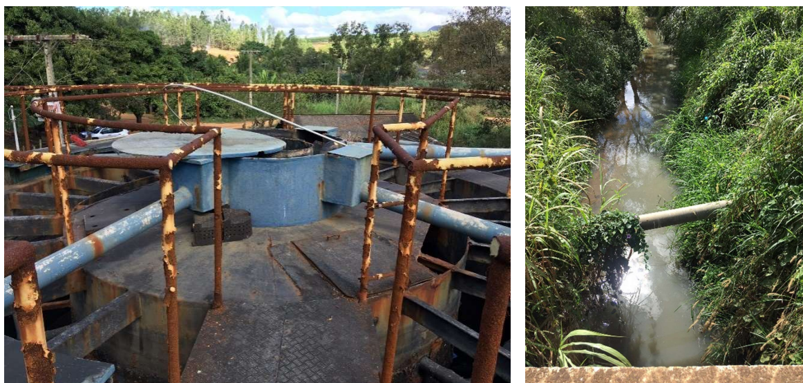
Figura 1. ETE da sede de Marilândia e Rio Liberdade a jusante do lançamento da ETE.
