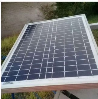
Painel solar encontra-se limpo.
