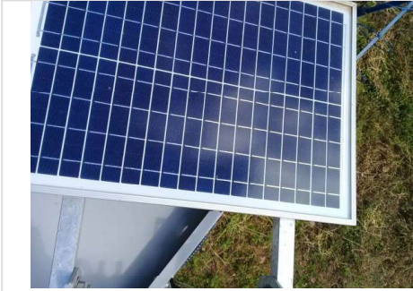
Estado de conservação do painel solar.
