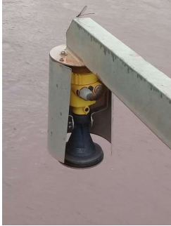
Estado de conservação do sensor de Nível Radar.
