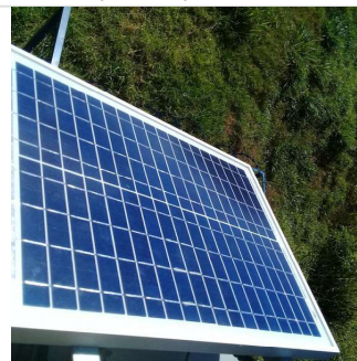
Painel solar novo instalado na estação.
