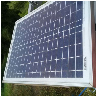
Painel solar apenas com leve camada de poeira.
