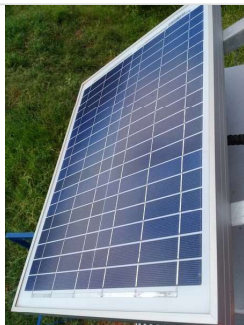
Painel solar encontra-se limpo.
