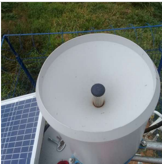
Pluviômetro encontra-se limpo e com passagem de água desobstruída.
