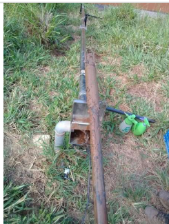
Foto da sonda de turbidez / qualidade da água - Antes da limpeza
