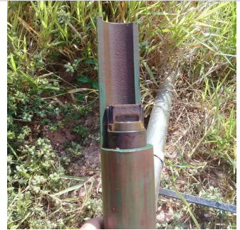
Foto da sonda de turbidez / qualidade da água - Antes da limpeza
