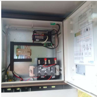
Componentes internos da PCD em perfeito estado de conservação.
