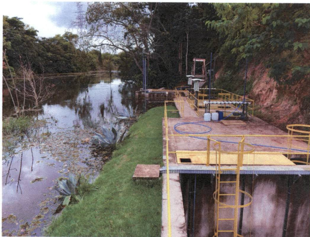
Sistema de Captação de Água Bruta
