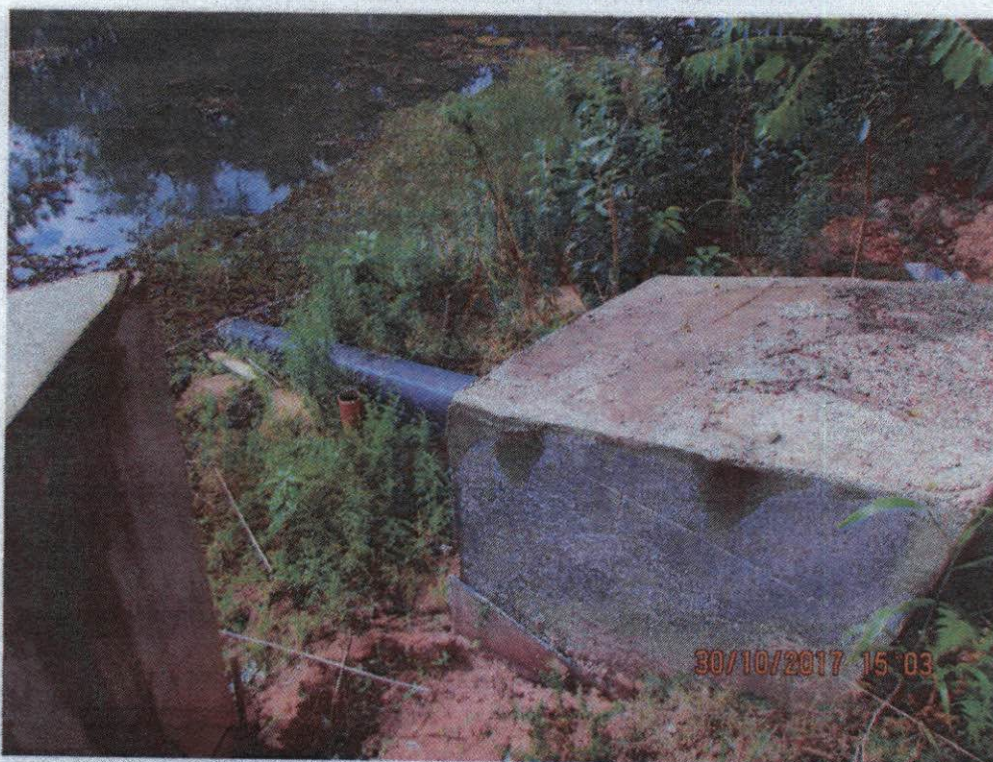
Rede adutora da Lagoa Nova
