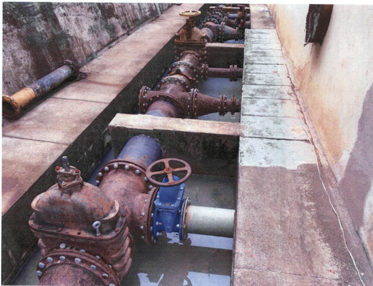
Linha de Recalque para Estação de Tratamento de Água
