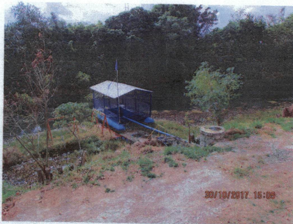
Sistema de captação pelo flutuante
