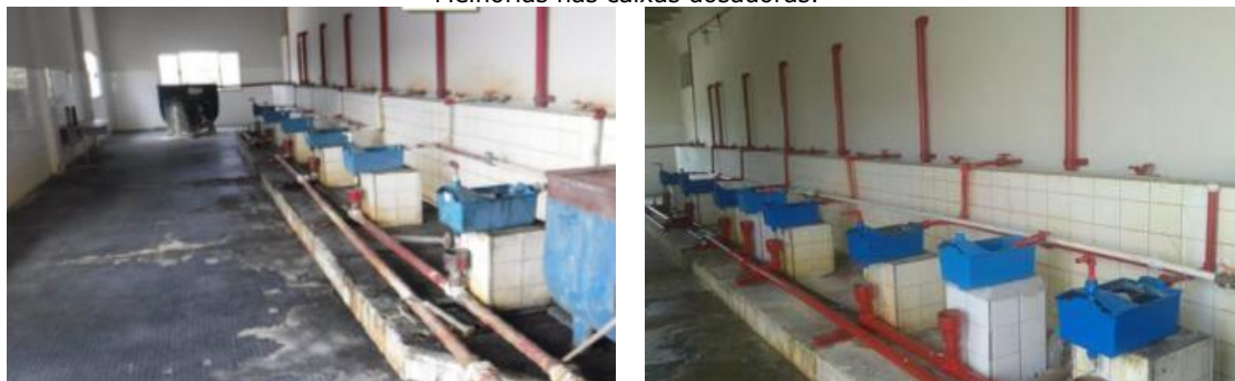
Melhorias nas caixas dosadoras.
