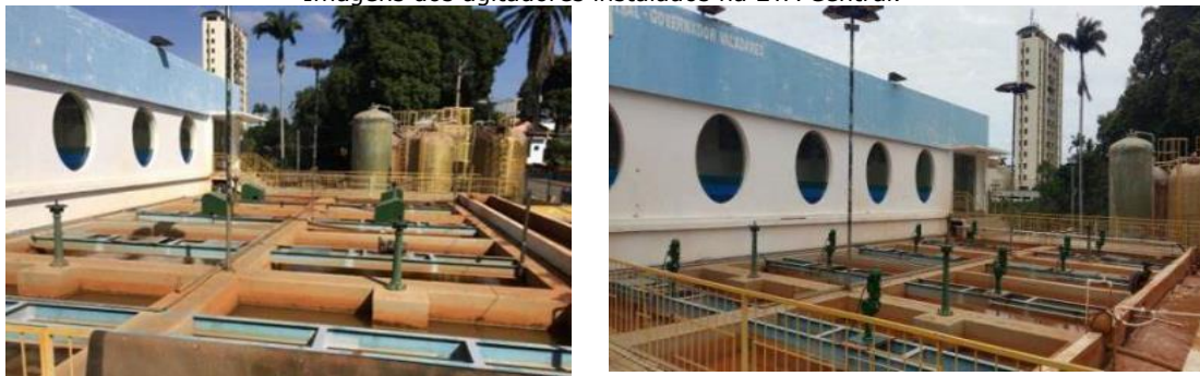
Imagens dos agitadores instalados na ETA Central.
