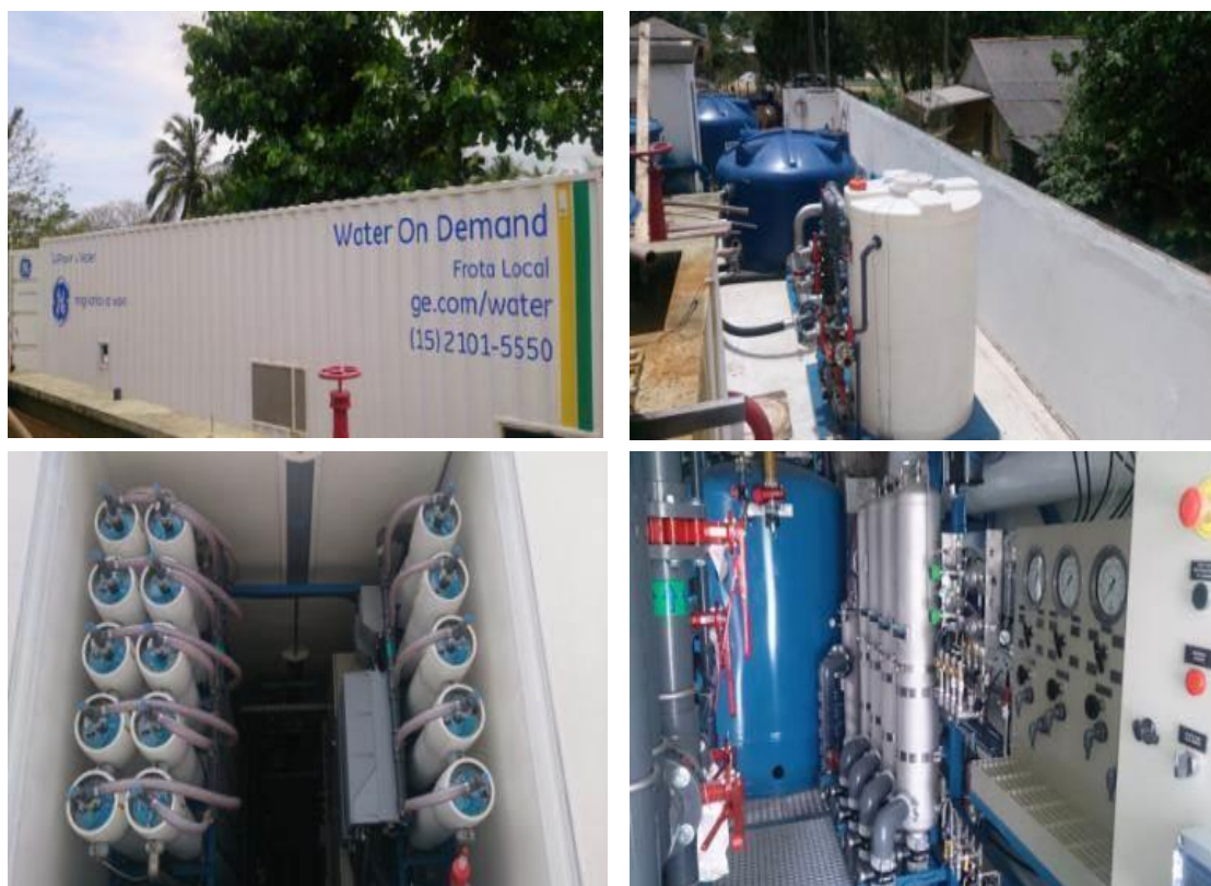
Imagens da Estação de Tratamento Móvel
