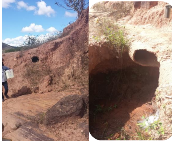
Adutora do Córrego Santaninha da COPASA.
