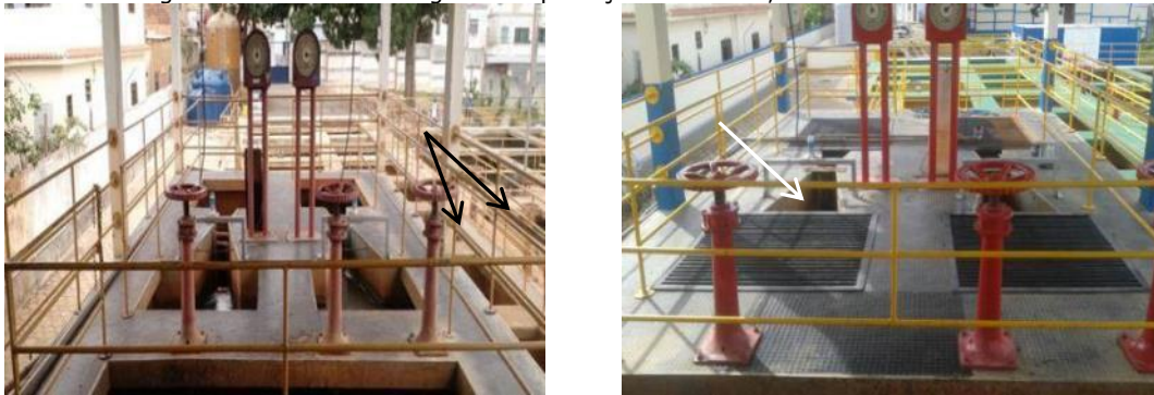
Figura 104 - Corrimão e grade de proteção instalados, ambos evidenciados.
