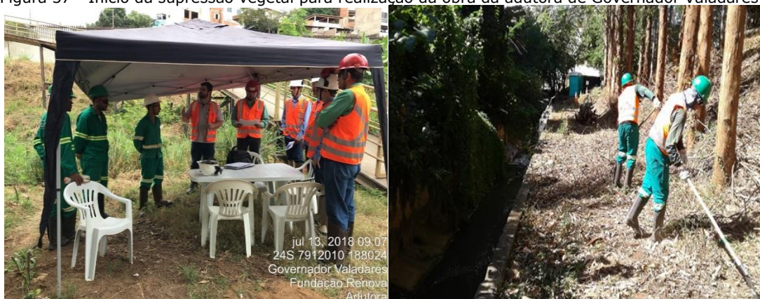
Figura 37 - Início da supressão vegetal para realização da obra da adutora de Governador Valadares
