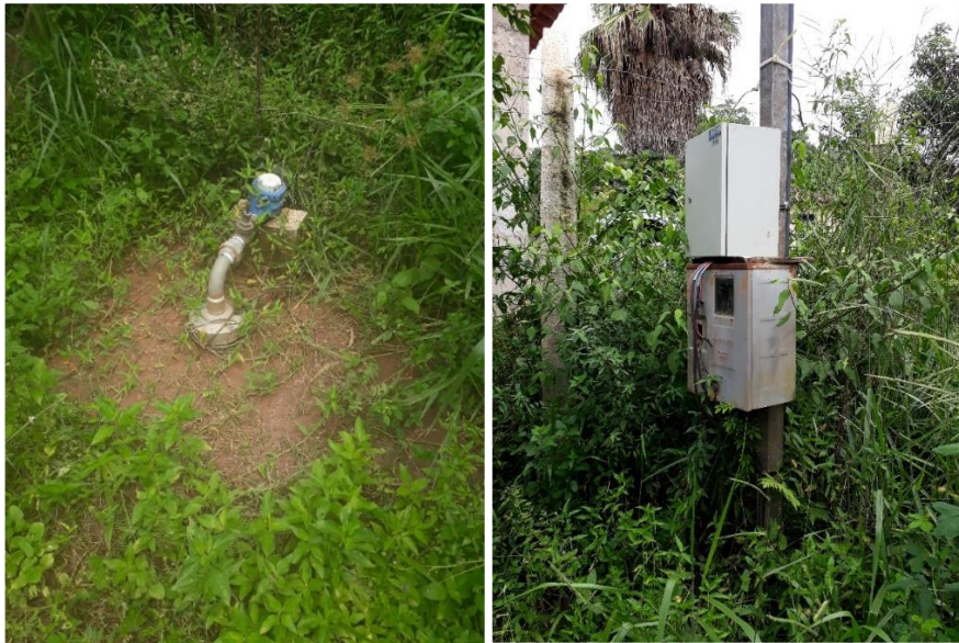
Figura 2 - Poço tubular da localidade (à esquerda) e painel de comando do poço (à direita)
