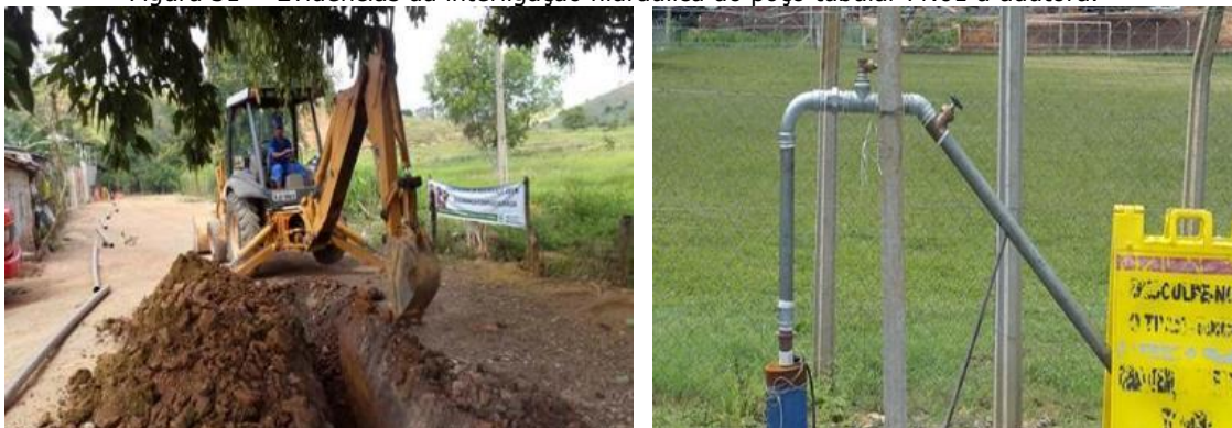
Figura 31 - Evidências da interligação hidráulica do poço tubular PN01 à adutora.
