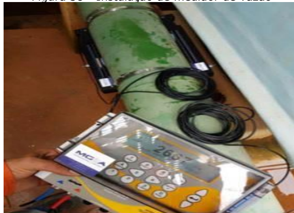
Figura 58 - Instalação de medidor de vazão
