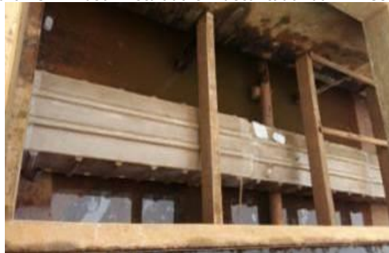
Figura 43 - Difusor instalado em decantador da ETA Central.
