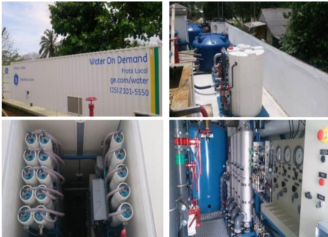
Figura 117 - Imagens da Estação de Tratamento Móvel
