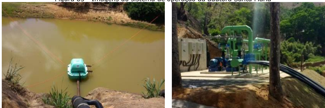
Figura 85 - Imagens do sistema de operação da adutora Santa Maria
