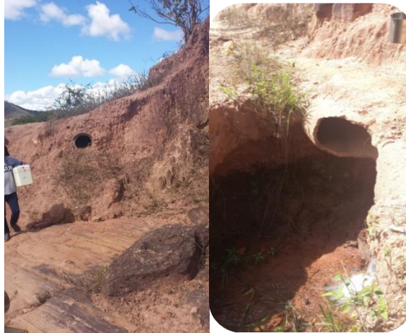
Figura 72 - Adutora do Córrego Santaninha da COPASA.
