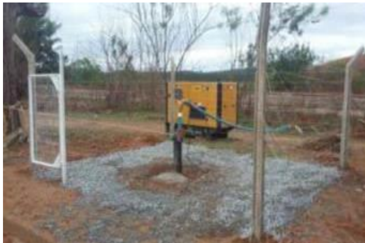
Figura 21 - Poço 03 em Belo Oriente, considerado para abastecimento emergencial.
