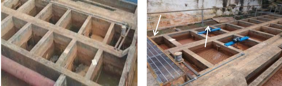
Figura 96 - Implantação de acesso seguro às áreas dos floculadores e decantadores, evidenciado.
