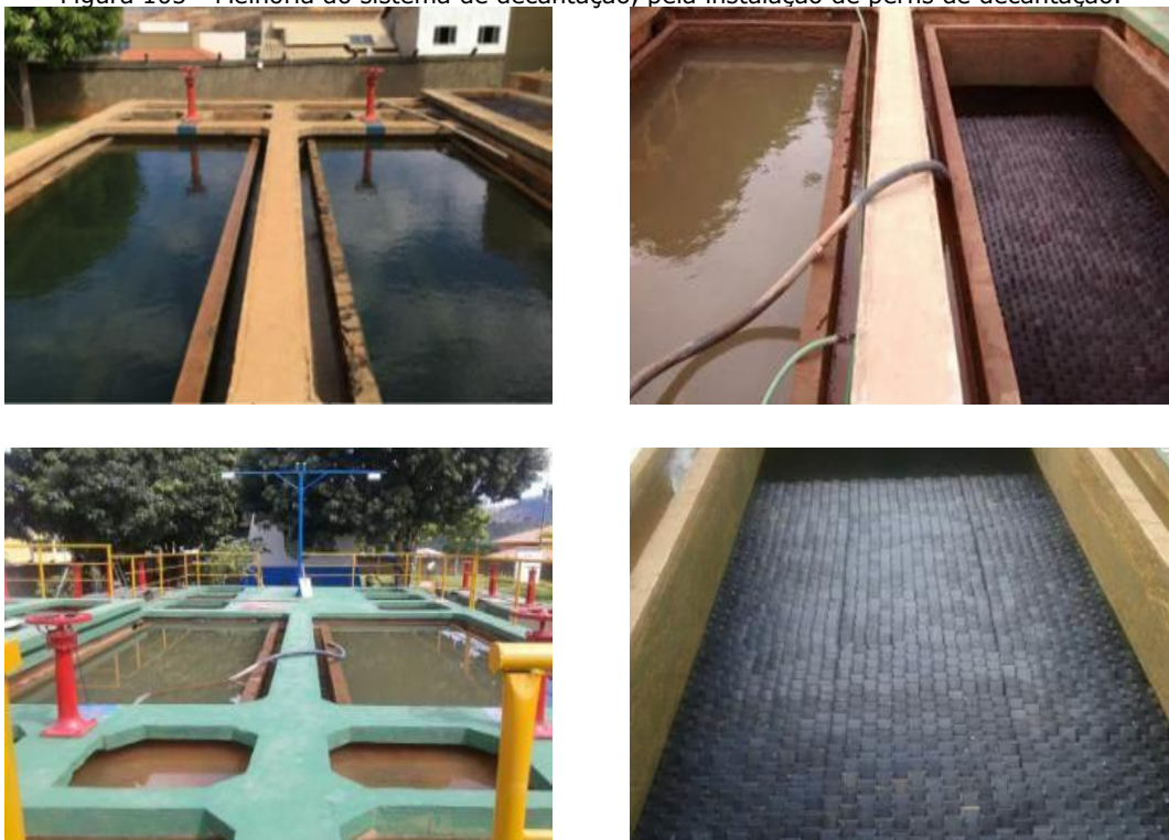
Figura 105 - Melhoria do sistema de decantação, pela instalação de perfis de decantação.
