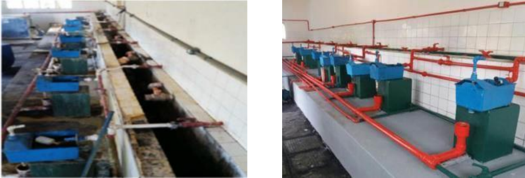
Figura 93 - Instalação de caixas dosadoras de produtos químicos na ETA I de Colatina.
