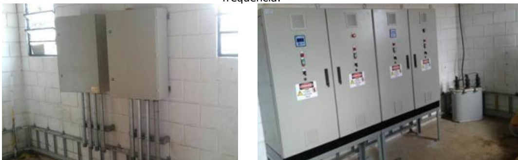
Figura 26 - Evidência de melhoria do sistema elétrico, após a instalação de painéis com inversores de frequência.
