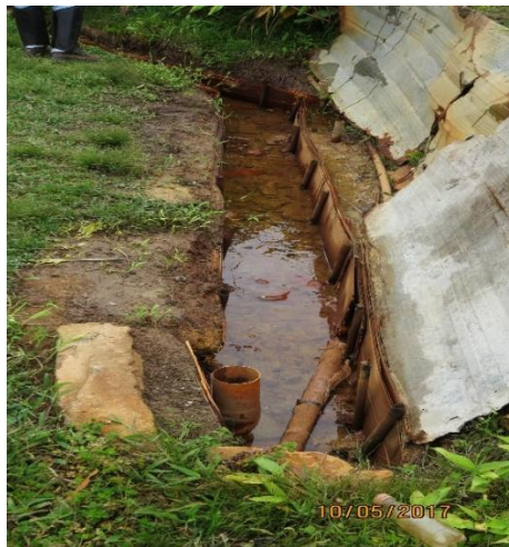
Figura 5 - Captação em nascente para abastecimento do distrito de Pedras
