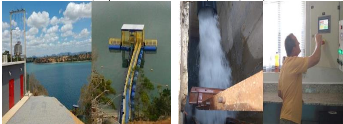
Figura 116 - Sistema de Bombeamento e Subestação (esquerda) e Chegada de água no SAAE e painel de operação Remota da adutora de Lagoa Nova (direita).
