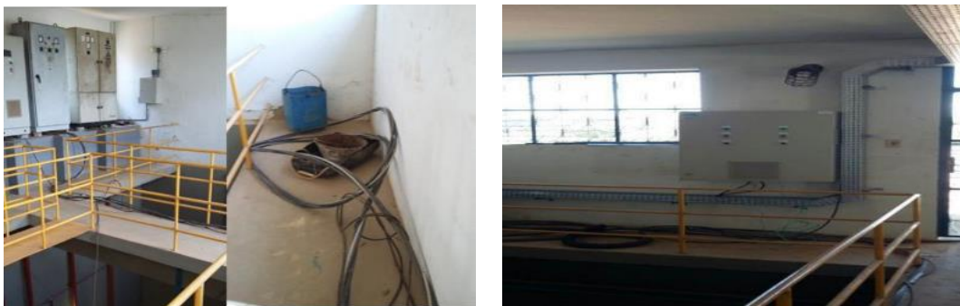
Figura 91 - Novo painel (à esquerda) e eletrocalha (à direita) instalados na ETA 1 de Colatina
