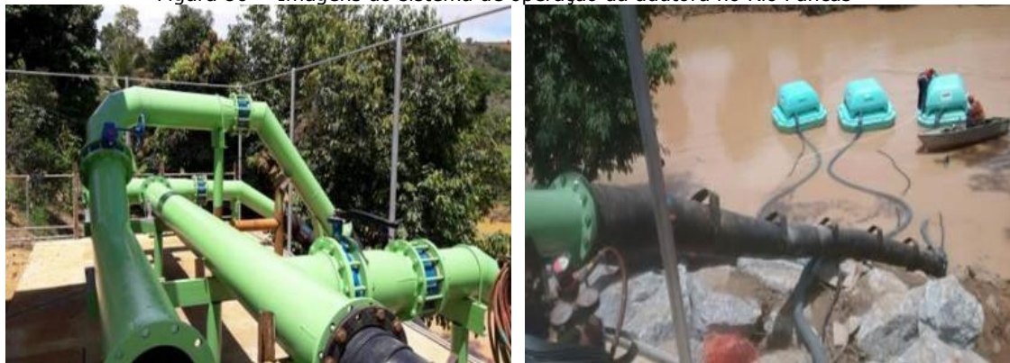
Figura 86 - Imagens do sistema de operação da adutora no Rio Pancas
