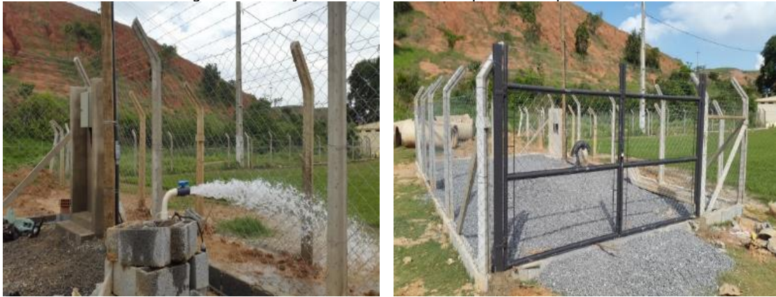
Figura 29 - Poço 01 na sede do município de Periquito.
