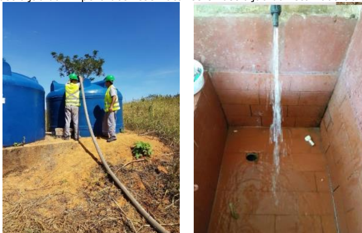
Figura 95 - Ilustração da limpeza dos reservatórios e ilustração da retomada do abastecimento.
