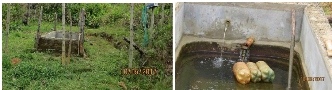
Figura 6 - Caixa de areia utilizada após a captação por nascente (à esquerda) e Detalhes de adaptações no sistema de bóias da caixa de areia (à direita)
