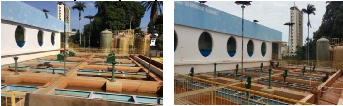
Figura 40: Imagens dos agitadores instalados na ETA Central.
