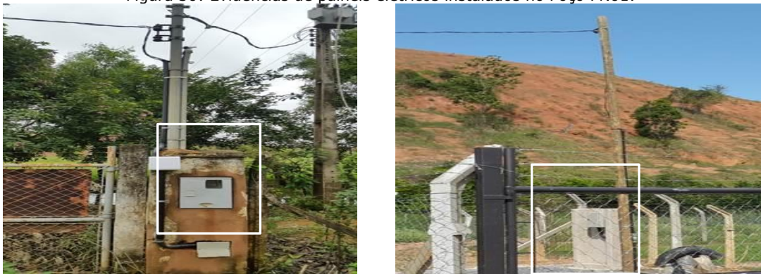
Figura 30: Evidências de painéis elétricos instalados no Poço PN01.
