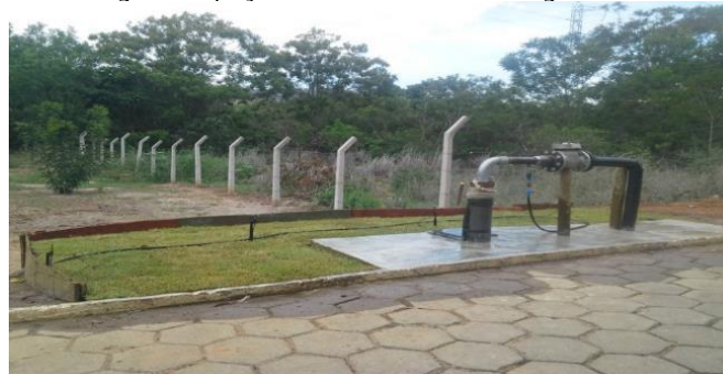
Figura 84 - Imagem do poço de Mascarenhas interligado a ETA do distrito.
