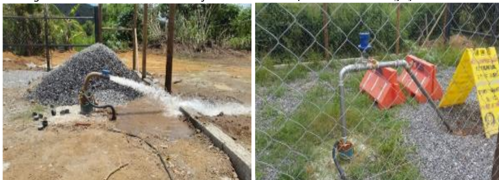
Figura 32 - Evidência da localização do PN02 à esquerda e da interligação à direita
