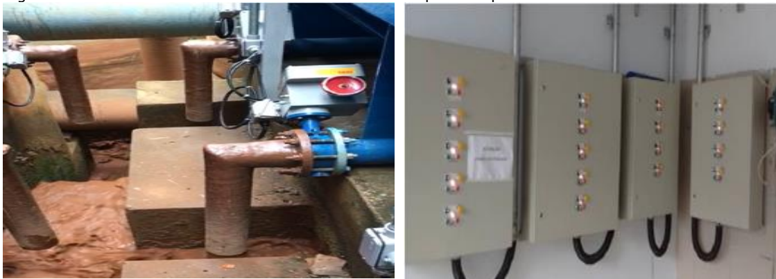
Figura 53 - Válvulas com acionamento automático à esquerda e painel de controle instalado à direita.
