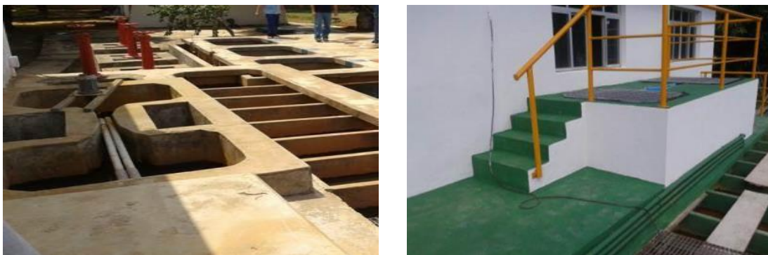
Figura 111 - Reforma da calha Parshall , à esquerda, e guarda corpos à direita.
