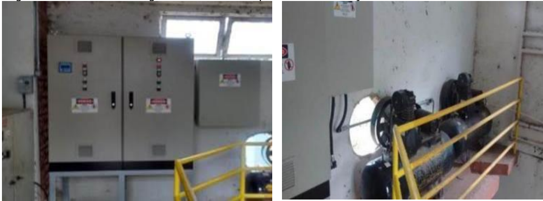
Figura 50 - Mosaico de imagens evidenciando o painel de alimentação e sistema de bombas anfíbias.
