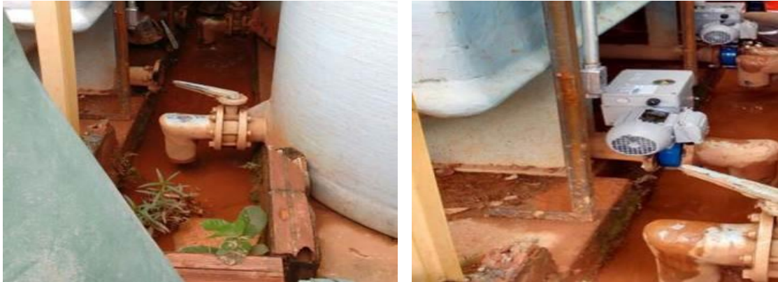
Figura 56: Imagem dos drenos dos decantadores da ETA Santa Rita, antes e depois da instalação das válvulas.
