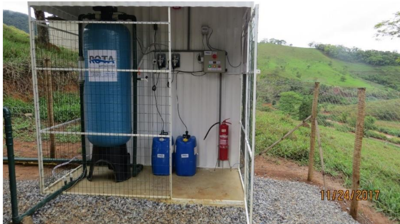
Figura 14 - Gesteira: Sistema de tratamento de água completo: Filtro, pintura da tubulação, bombonas com produtos químicos, bombas dosadoras, quadro de comando etc.
