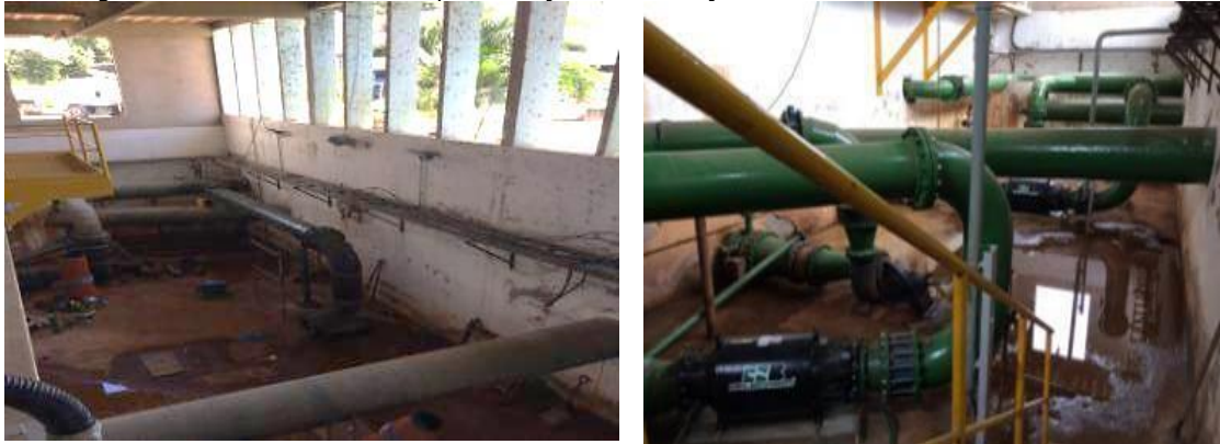
Figura 39 - Cenário antes e depois da ação da instalação das duas novas bombas anfíbias.
