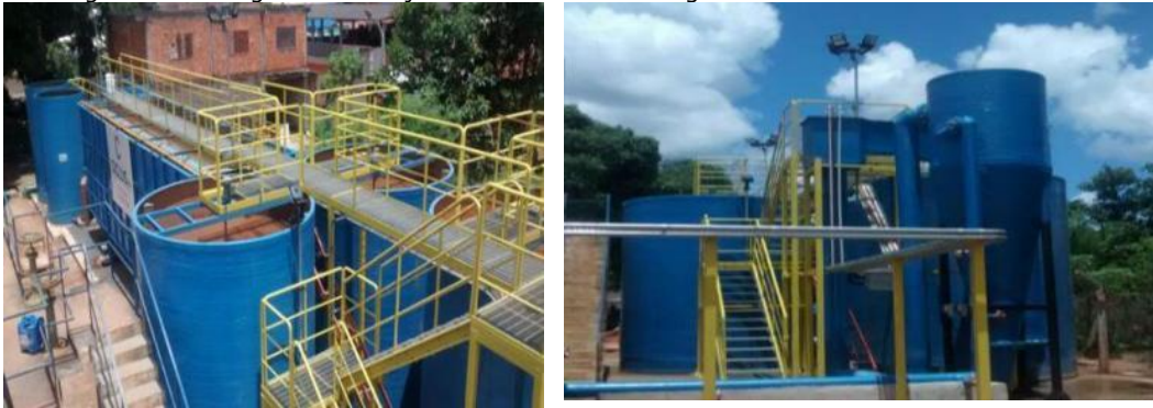
Figura 24 - Imagens da Estação de Tratamento de Água Modular de Cachoeira Escura
