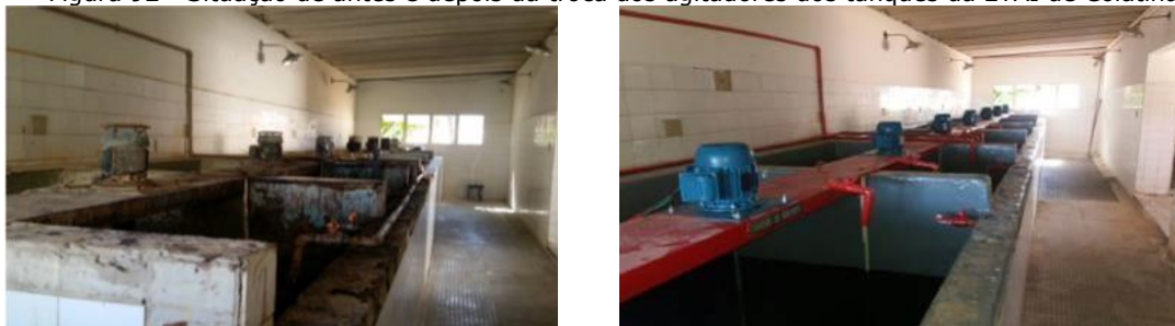
Figura 92 - Situação de antes e depois da troca dos agitadores dos tanques da ETAI de Colatina.
