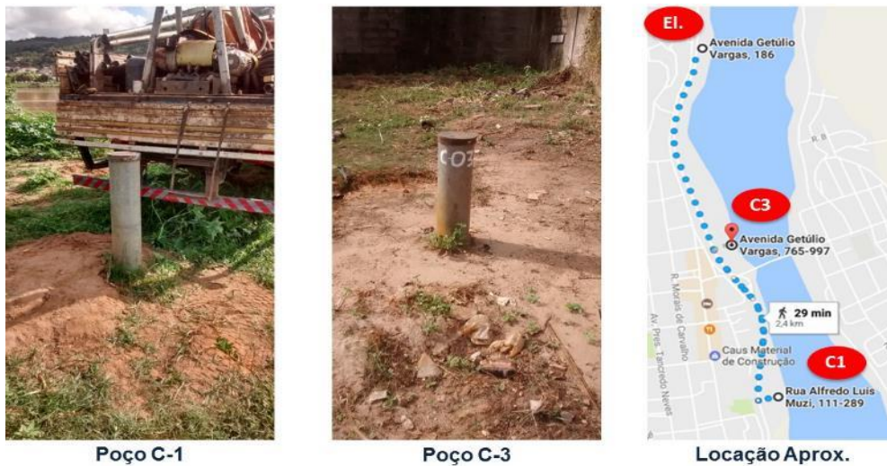
Figura 76 - Imagens dos poços PC 1 com vazão de 18,5 L/s (a esquerda) e PC3 com vazão de 6,8 L/s (central) e, mapa com espacialização dos poços.
