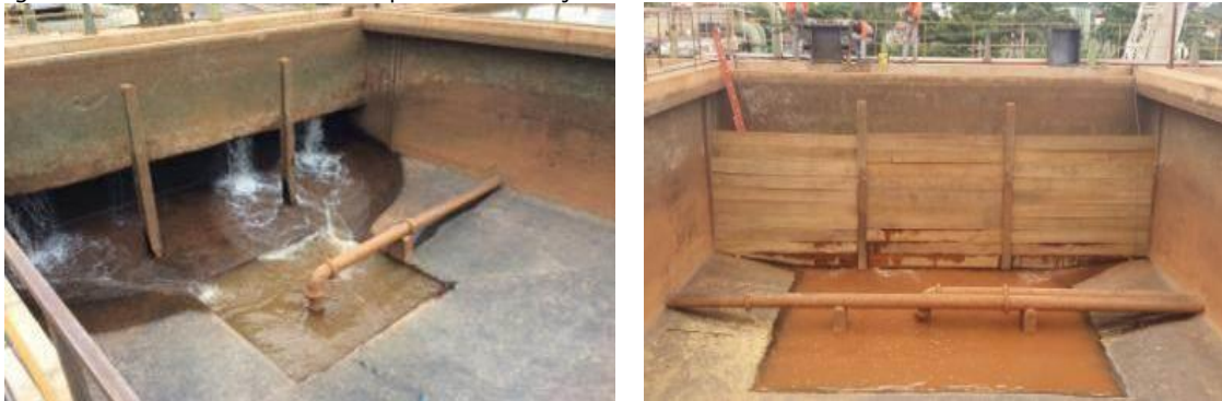
Figura 42 - Cenário de antes e depois da instalação de cortina de madeira na entrada do Decantador 02
