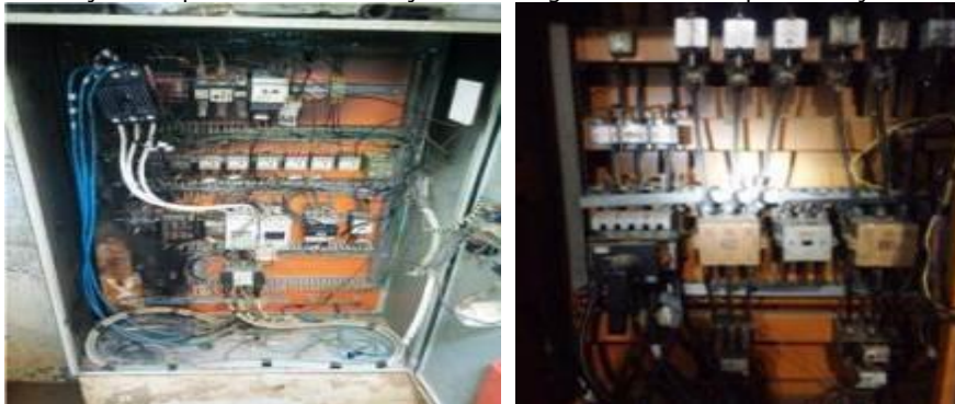
Figura 25 - Situação dos painéis de distribuição de tensão antes da implementação de melhorias.
