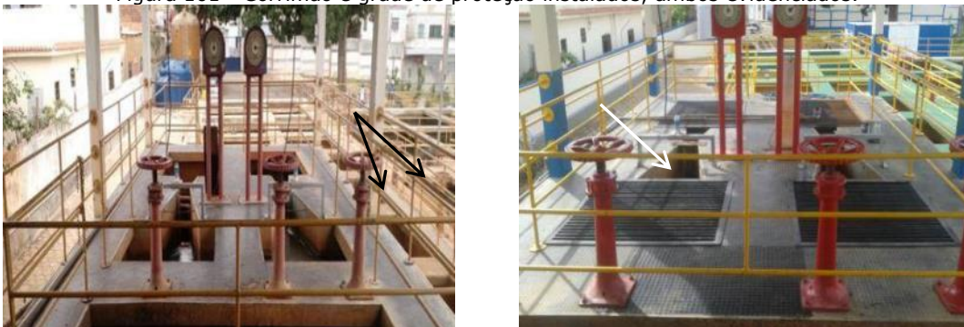
Figura 101 - Corrimão e grade de proteção instalados, ambos evidenciados.
