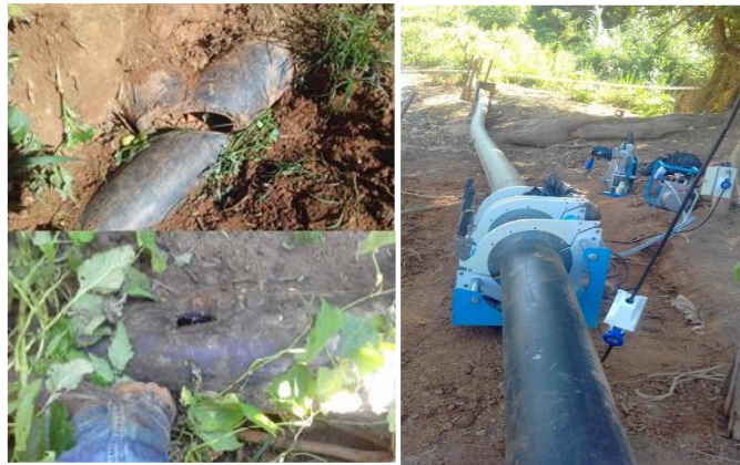
Figura 109 - Reparo e interligação da adutora dos poços; adutora antes do reparo (à esquerda) e após o reparo (à direita)
