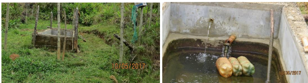
Figura 6 - Caixa de areia utilizada após a captação por nascente (à esquerda) e Detalhes de adaptações no sistema de bóias da caixa de areia (à direita)
