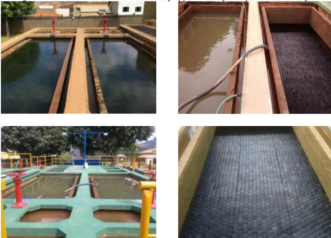
Figura 102 - Melhoria do sistema de decantação, pela instalação de perfis de decantação.
