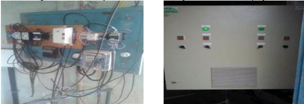
Figura 104 - Substituição do Pannel de Alimentação das Bombas da Captação
