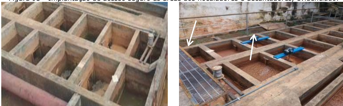
Figura 93 - Implantação de acesso seguro às áreas dos floculadores e decantadores, evidenciado.
