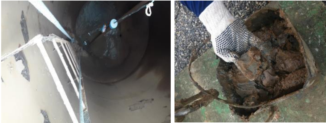
Figura 60 - Interior da torre antes da reforma (à esquerda) e material lodoso retirado no interior do castelo d'água
