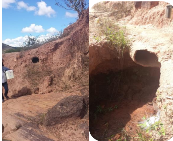
Figura 70 - Adutora do Córrego Santaninha da COPASA.
