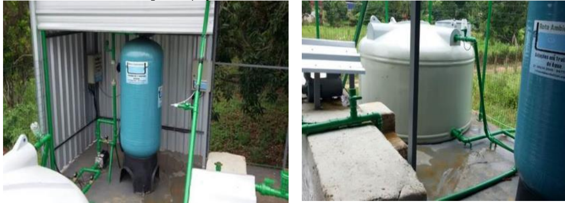
Figura 59 - Imagem do filtro (à esquerda) e do reservatório (à direita) do sistema de tratamento da água do poço do distrito de São Tomé do Rio Doce.
