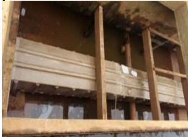
Figura 42 - Difusor instalado em decantador da ETA Central.
