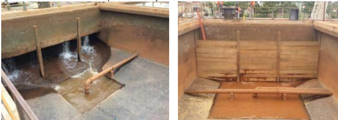
Figura 41 - Cenário de antes e depois da instalação de cortina de madeira na entrada do Decantador 02
