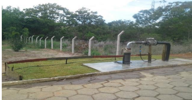
Figura 81 - Imagem do poço de Mascarenhas interligado a ETA do distrito.
