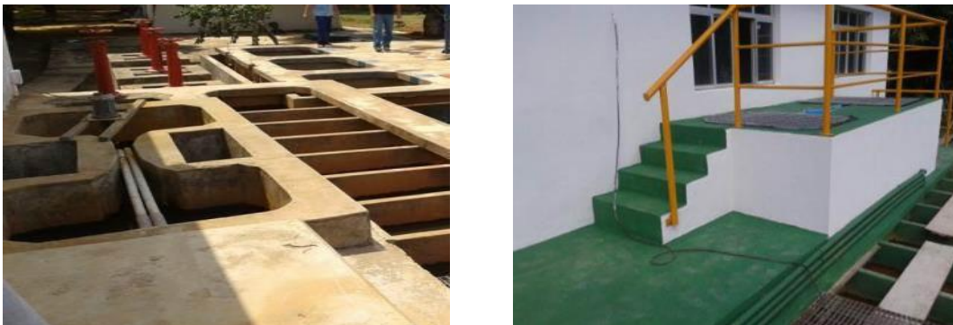
Figura 108 - Reforma da calha Parshall , à esquerda, e guarda corpos à direita.
