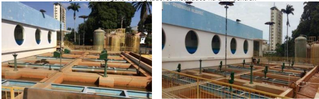
Figura 39: Imagens dos agitadores instalados na ETA Central.
