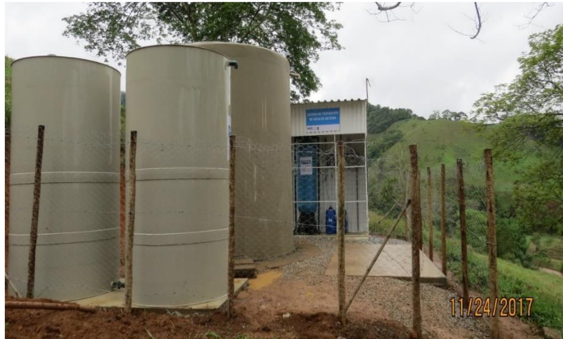
Figura 13 - Vista do sistema de tratamento de água e reservação (dois novos reservatórios de 5 m 3 cada um) do Distrito de Gesteira
