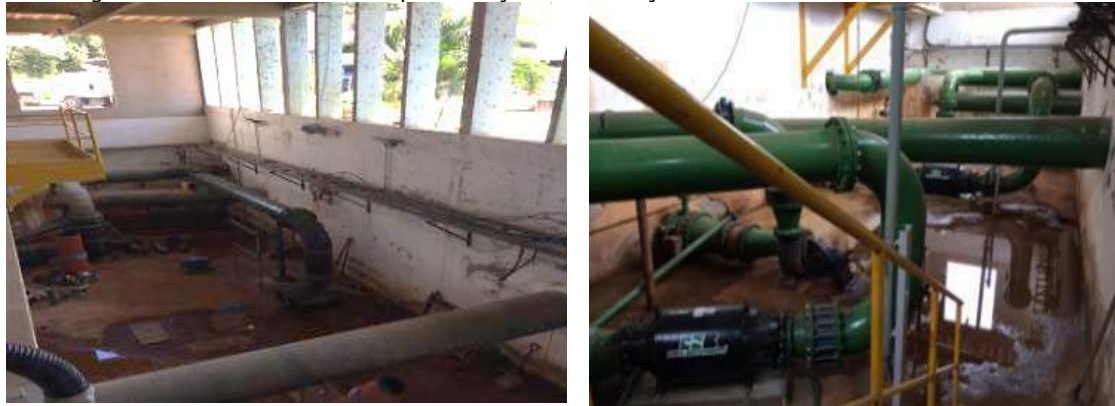
Figura 38 - Cenário antes e depois da ação da instalação das duas novas bombas anfíbias.
