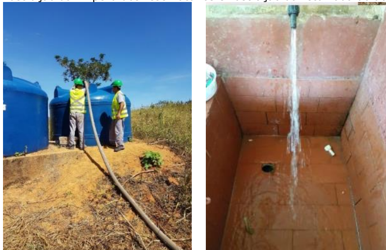
Figura 11 - Ilustração da limpeza dos reservatórios e ilustração da retomada do abastecimento.
