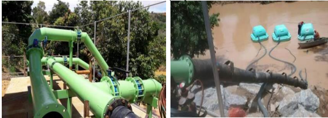
Figura 83 - Imagens do sistema de operação da adutora no Rio Pancas
