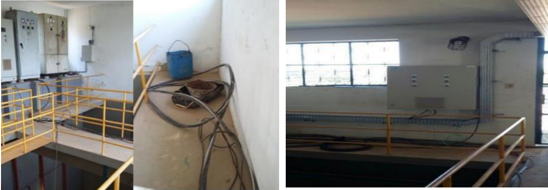
Figura 88 - Novo painel (à esquerda) e eletrocalha (à direita) instalados na ETA 1 de Colatina
