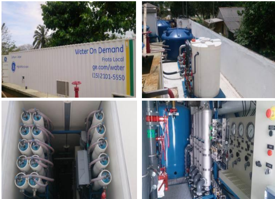
Figura 115 - Imagens da Estação de Tratamento Móvel
