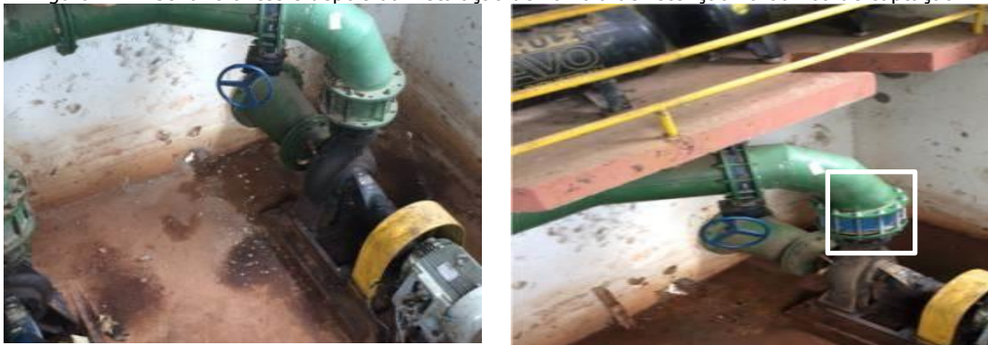
Figura 47 - Cenário antes e depois da instalação de válvula de retenção na bomba de captação.
