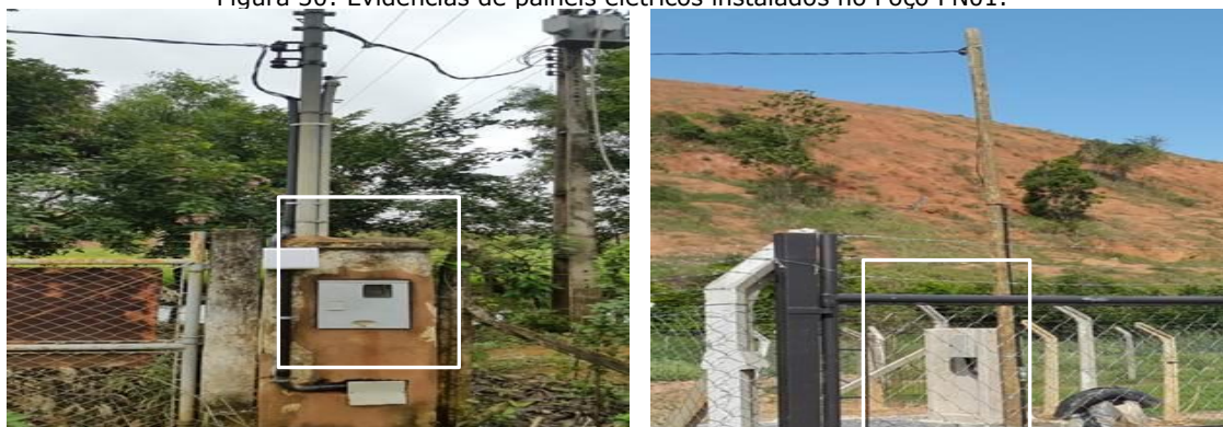
Figura 30: Evidências de painéis elétricos instalados no Poço PN01.
