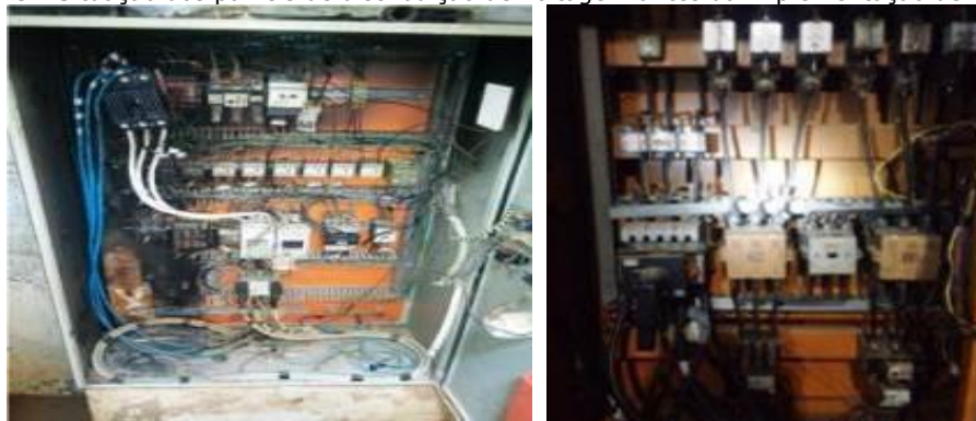
Figura 25 - Situação dos painéis de distribuição de voltagem antes da implementação de melhorias.
