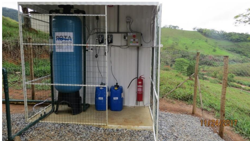
Figura 14 - Gesteira: Sistema de tratamento de água completo: Filtro, pintura da tubulação, bombonas com produtos químicos, bombas dosadoras, quadro de comando etc.
