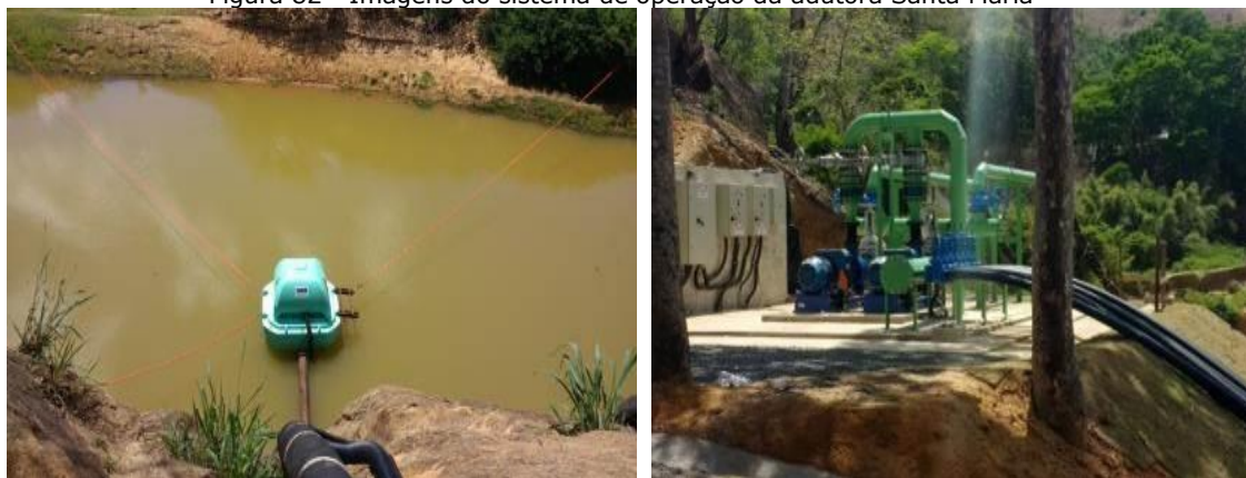
Figura 82 - Imagens do sistema de operação da adutora Santa Maria
