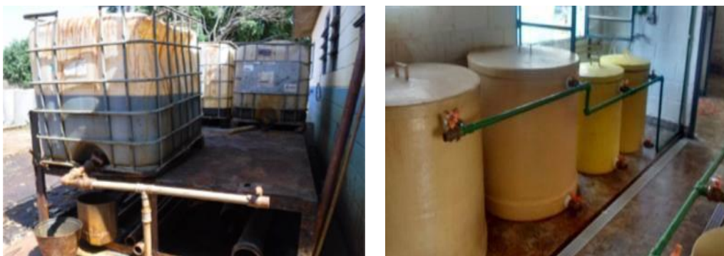
Figura 27 - Melhoria das condições de armazenamento dos produtos químicos na Casa de Química da ETA de Cachoeira Escura (Distrito de Belo Oriente) (antes e depois).
