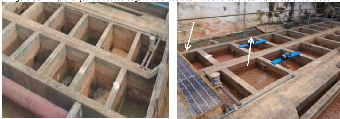
Figura 93 - Implantação de acesso seguro às áreas dos floculadores e decantadores, evidenciado.
