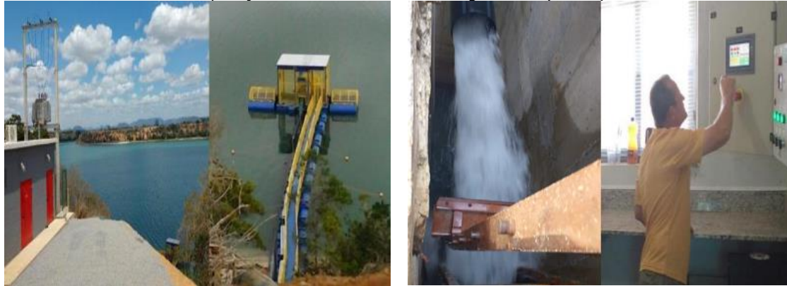
Figura 114 - Sistema de Bombeamento e Subestação (esquerda) e Chegada de água no SAAE e painel de operação Remota da adutora de Lagoa Nova (direita).
