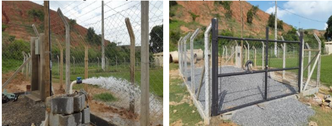
Figura 29 - Poço 01 na sede do município de Periquito.
