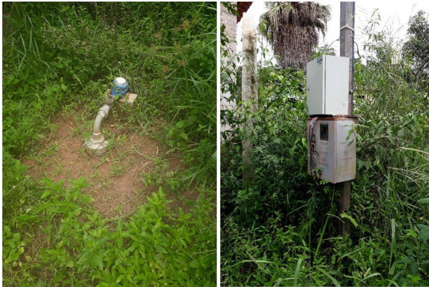
Figura 2 - Poço tubular da localidade (à esquerda) e painel de comando do poço (à direita)
