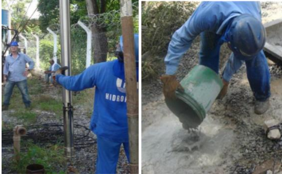
Figura 22 – Içamento de bomba submersa na figura esquerda e tamponamento de poço na figura direita
