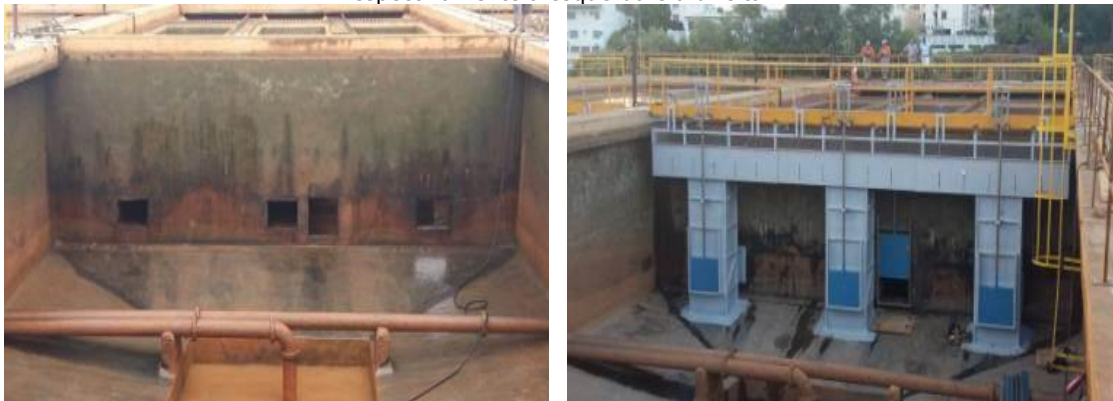
Figura 40 - Melhoria da decantação pela instalação de calhas de overflow , cenário de antes e depois, respectivamente à esquerda e à direita.
