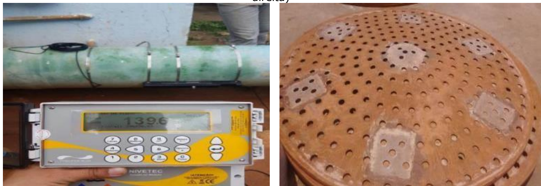
Figura 50 - Sistema de medição melhorado (à esquerda) e manutenção de anel de floculador (à direita)
