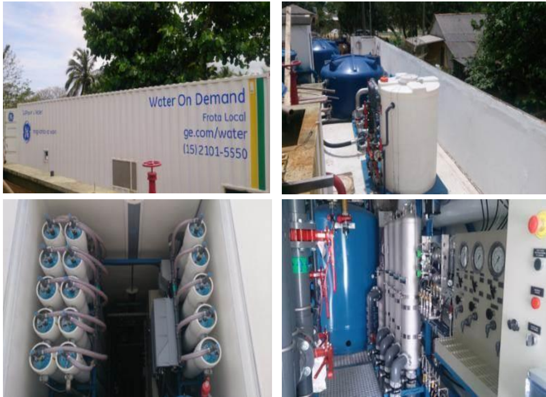
Figura 115 - Imagens da Estação de Tratamento Móvel
