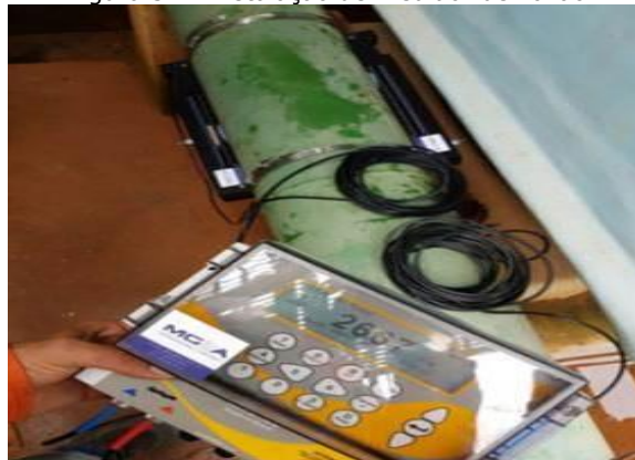
Figura 57 - Instalação de medidor de vazão
