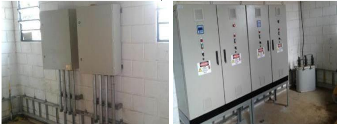
Figura 26 - Evidência de melhoria do sistema elétrico, após a instalação de painéis com inversores de frequência.
