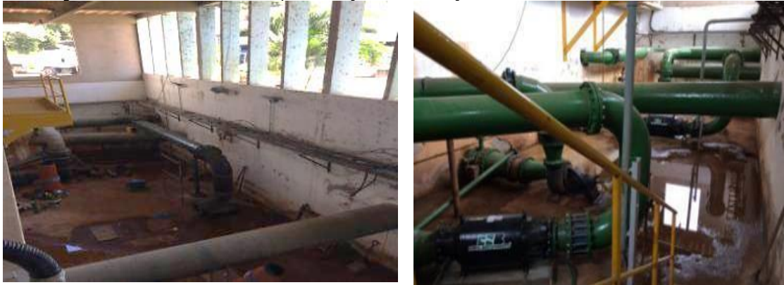
Figura 38 - Cenário antes e depois da ação da instalação das duas novas bombas anfíbias.
