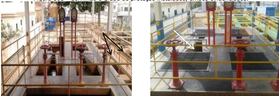
Figura 101 - Corrimão e grade de proteção instalados, ambos evidenciados.
