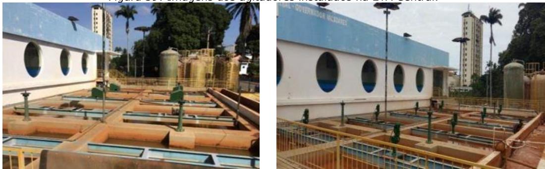
Figura 39: Imagens dos agitadores instalados na ETA Central.
