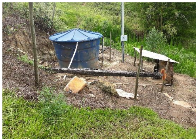
Figura 7 - Reservatório intermediário e bomba de recalque atualmente instalados no distrito de Pedras
