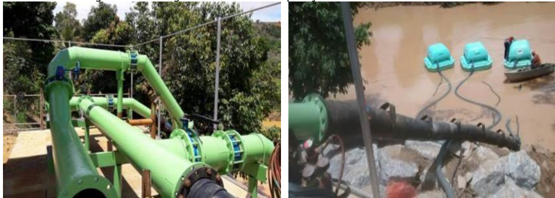
Figura 83 - Imagens do sistema de operação da adutora no Rio Pancas
