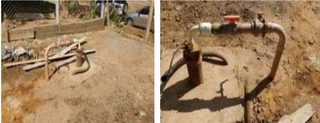
Figura 20 - Poço já perfurado em Belo Oriente, interligado à Estação de Tratamento de Água de Cachoeira Escura
