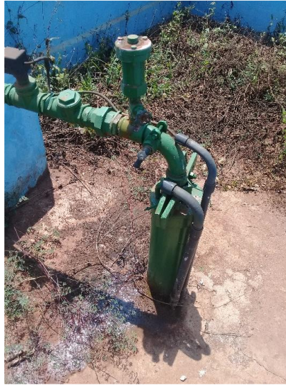
Figura 10 - Poço Beira Rio, utilizado como fonte principal de abastecimento de Gesteira.
