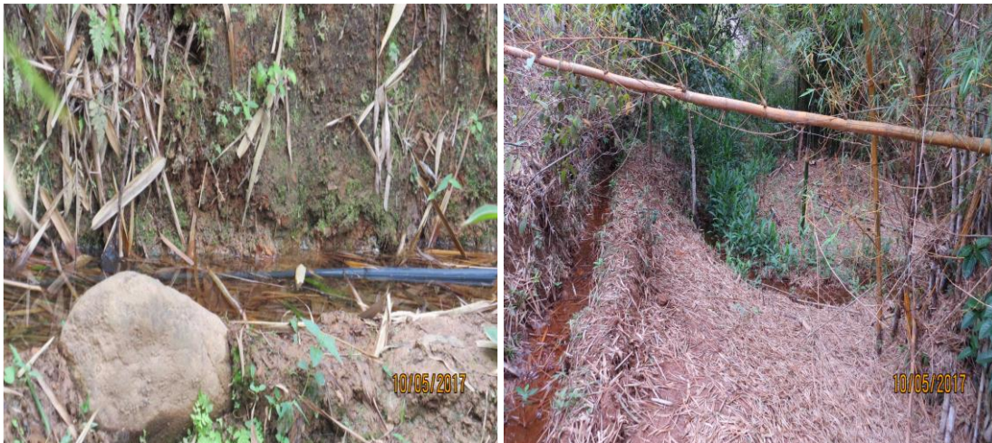
Figura 16 - (à esquerda) Detalhe de captação em nascente para abastecimento de residências no distrito de Barreto - (à direita) Captação em nascente na localidade de Barreto
