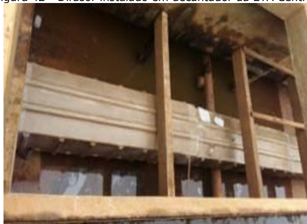
Figura 42 - Difusor instalado em decantador da ETA Central.
