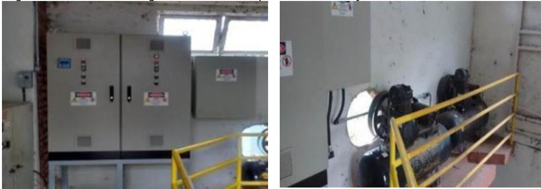
Figura 49 - Mosaico de imagens evidenciando o painel de alimentação e sistema de bombas anfíbias.
