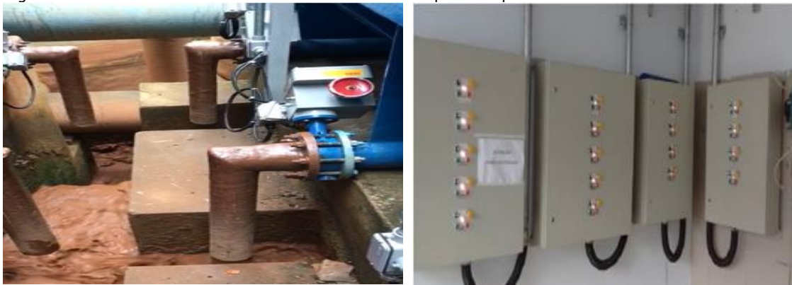
Figura 52 - Válvulas com acionamento automático à esquerda e painel de controle instalado à direita.
