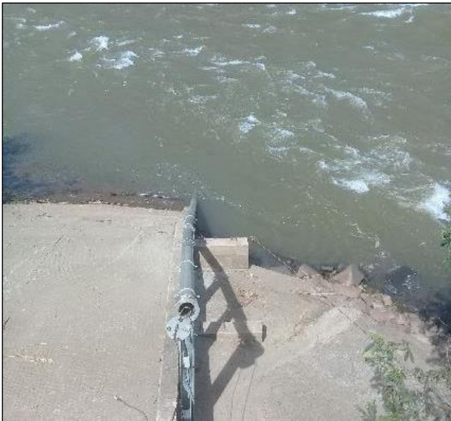
Figura 16 - Estação RDO 02 (rio Doce – jusante UHE Risoleta Neves) em 17/05/2018, após a substituição do pír por conjunto de tubulação – Vista superior.
