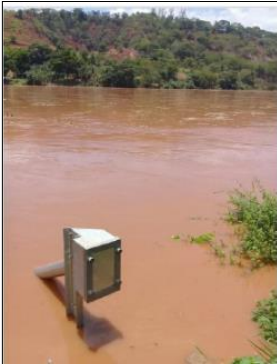
Figura 21 - Caixa de acesso a sonda da RDO 05 (rio Doce - Belo Oriente) parcialmente submersa no dia 05/12/2017.
