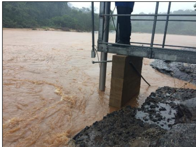
Figura 19 - Estrutura dos cabos da RDO 04 (rio Doce – Parque Estadual do Rio Doce) danificada em 11/12/2017.
