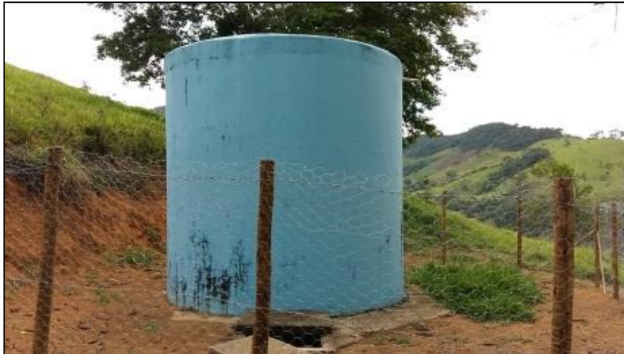
Figura 13 - Reservatório antigo, com capacidade de 15 m 3 , em Gesteira
