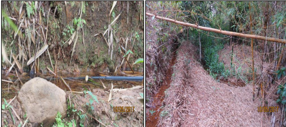
Figura 18 - (à esquerda) Detalhe de captação em nascente para abastecimento de residências no distrito de Barreto - (à direita) Captação em nascente na localidade de Barreto
