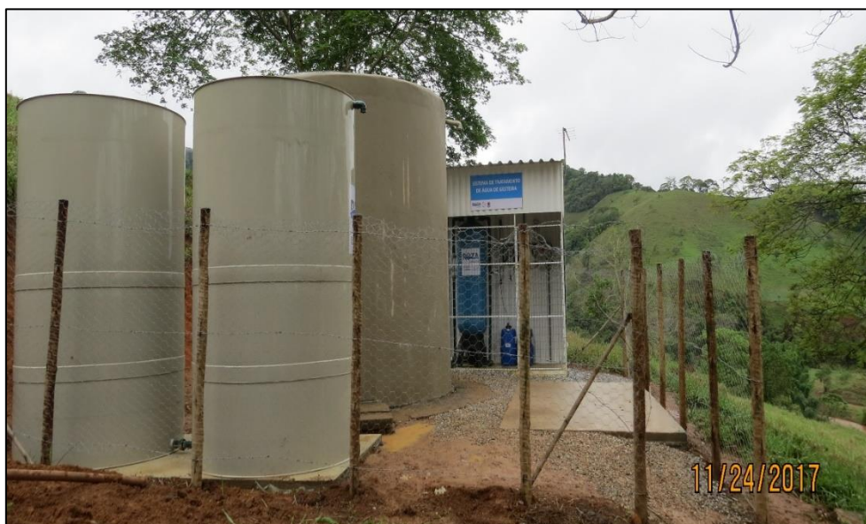
Figura 15 - Vista do sistema de tratamento de água e reservação (dois novos reservatórios de 5 m 3 cada um) do Distrito de Gesteira
