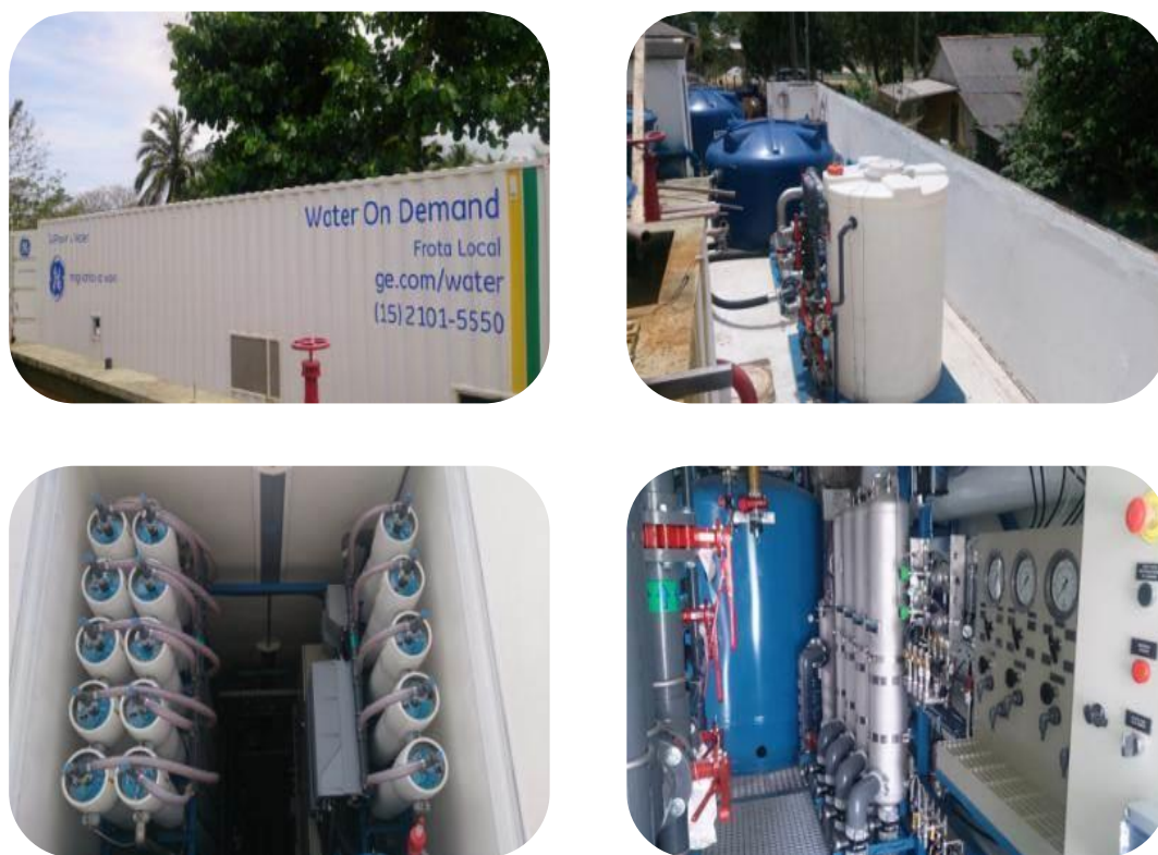
Figura 114 - Imagens da Estação de Tratamento Móvel.
