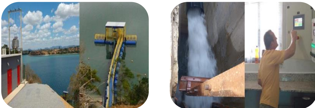
Figura 113 - Sistema de Bombeamento e Subestação (esquerda) e Chegada de água no SAAE e painel de operação Remota da adutora de Lagoa Nova (direita).
