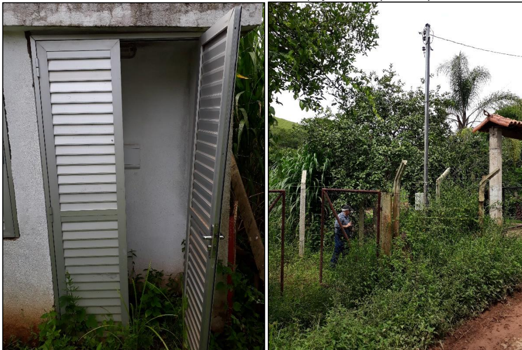
Figura 3: Estrutura construída no local do poço encontra-se danificada e sem uso (à esquerda) e Entrada do local onde está localizado o poço tubular (à direita).
