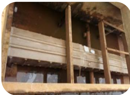
Figura 42 - Difusor instalado em decantador da ETA Central.
