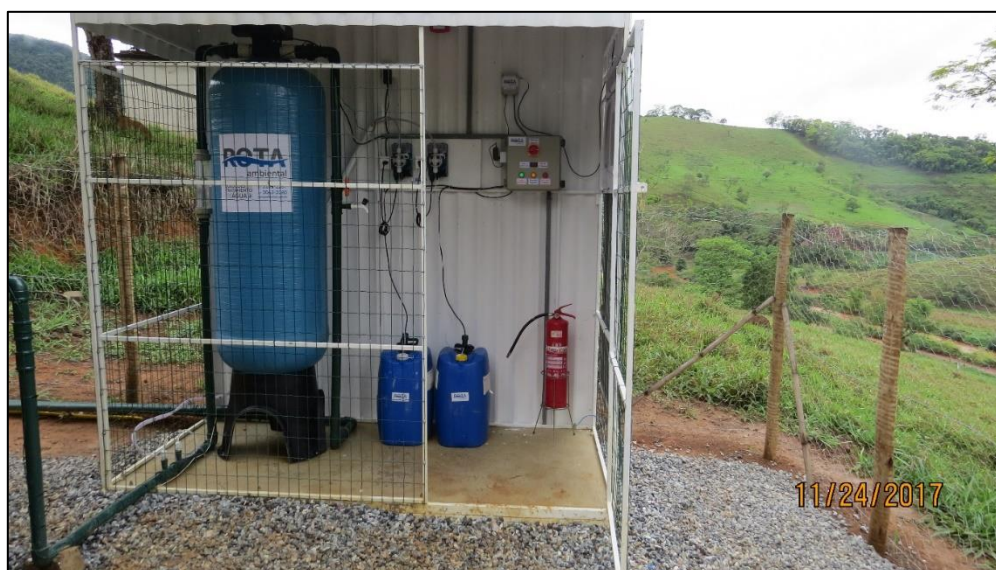
Figura 16 - Gesteira: Sistema de tratamento de água completo: Filtro, pintura da tubulação, bombonas com produtos químicos, bombas dosadoras, quadro de comando etc.
