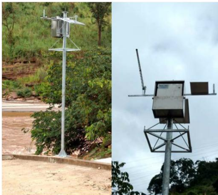
Poste e painel de monitoramento
