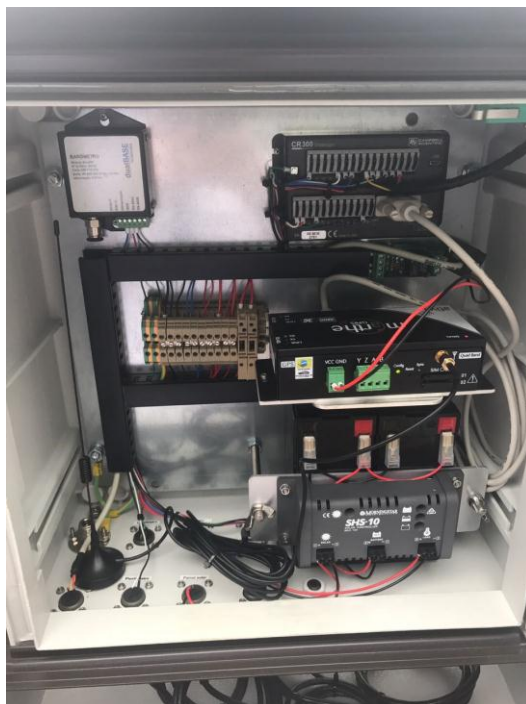
Detalhe interno do painel
