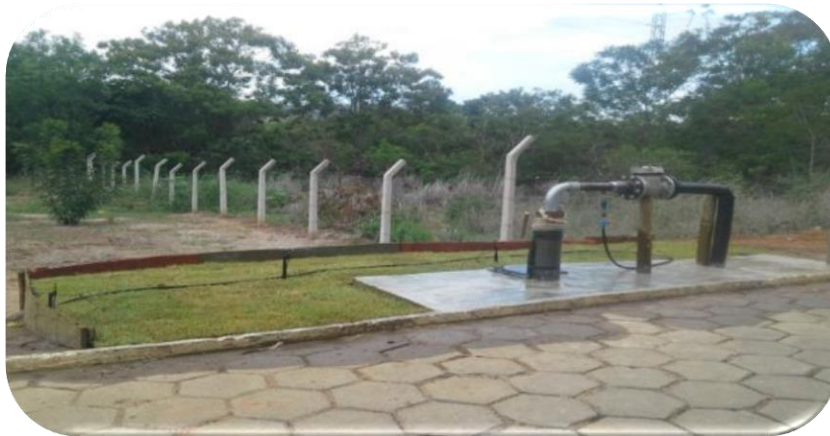
Figura 99. Imagem do poço de Mascarenhas interligado a ETA do distrito.
