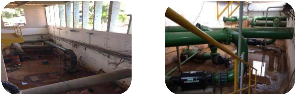
Figura 10: Cenário antes e depois da ação da instalação das duas novas bombas anfíbias.
