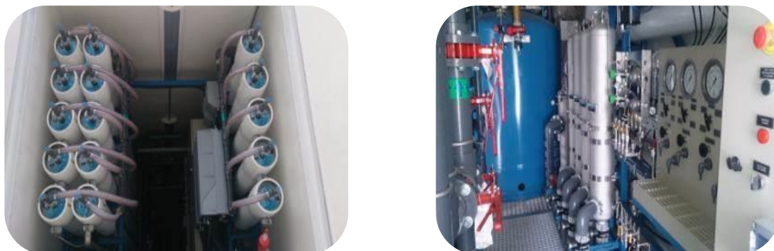
Figura 64: Imagens da Estação de Tratamento Móvel.
