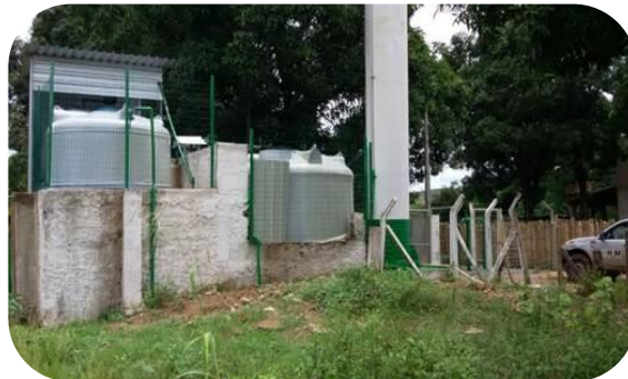
Figura 30: Área de sistema de captação por poço, que teve ação de melhoria.
