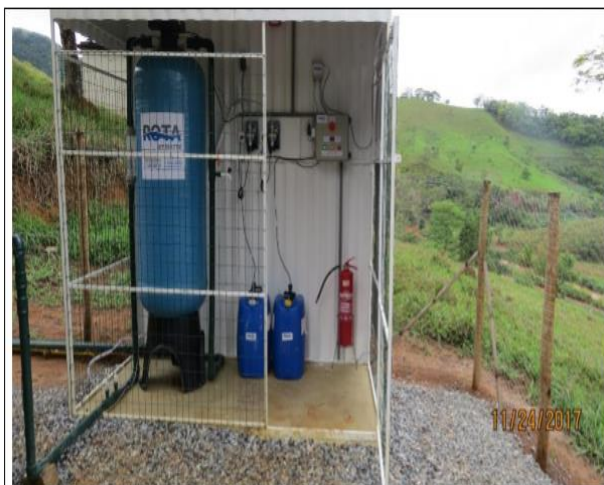
Figura 35 - Sistema de tratamento de água completo: Filtro, pintura da tubulação, bombonas com produtos químicos, bombas dosadoras, quadro de comando etc.
