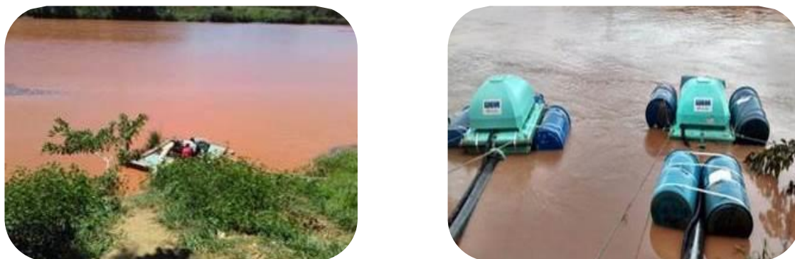
Figura 6: Substituição da balsa de captação (à esquerda) por dois flutuadores (à direita) no sistema de captação da ETA modular de Cachoeira Escura.
