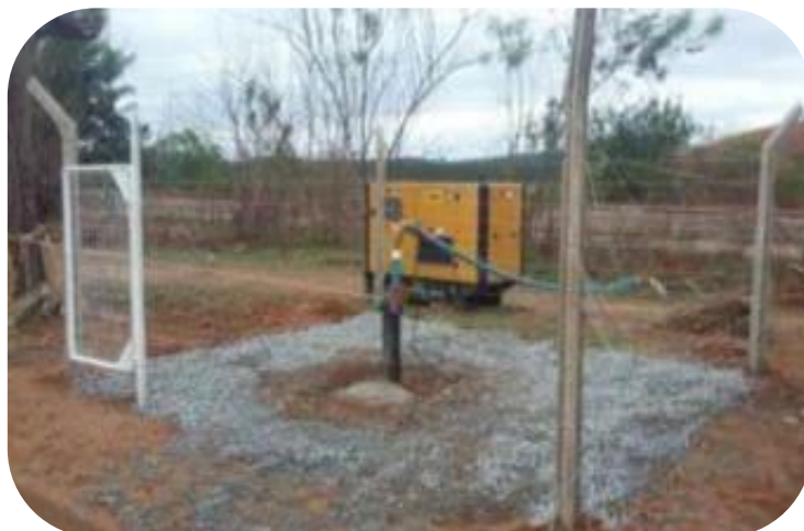
Figura 73: Poço 03 de Belo Oriente, considerado para abastecimento emergencial.
