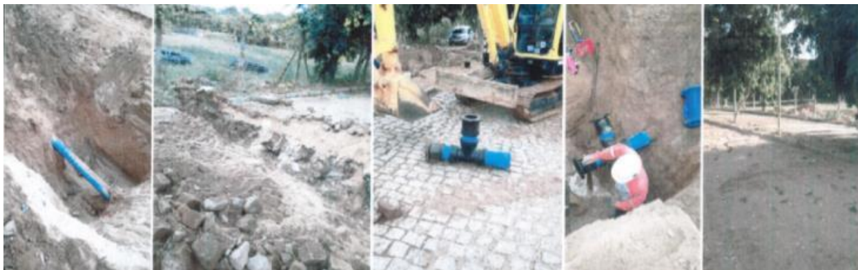
Figura 98: Poço de Aimorés, com vazão aproximada de 8,57 L/s, interligado na adutora de captação do Rio Doce.
