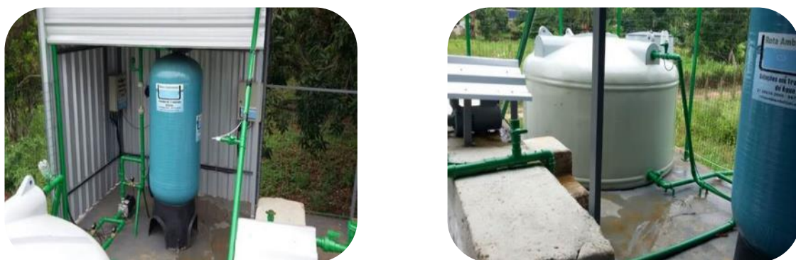
Figura 31: Imagem do filtro (à esquerda) e do reservatório (à direita) do sistema de tratamento da água do poço do distrito de São Tomé do Rio Doce.
