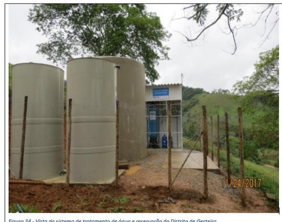
Figura 34 - Vista do sistema de tratamento de água e reservação do Distrito de Gesteira.
