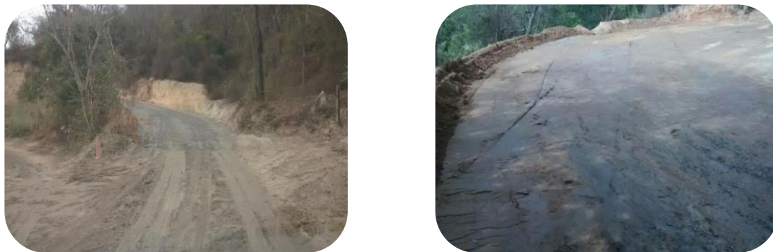
Figura 37: Lançamento de solo brita (à esquerda) e compactação da via de acesso (à direita)
