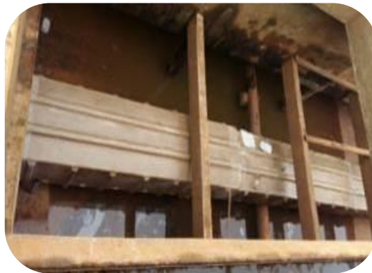
Figura 14: Difusor instalado em decantador da ETA Central.
