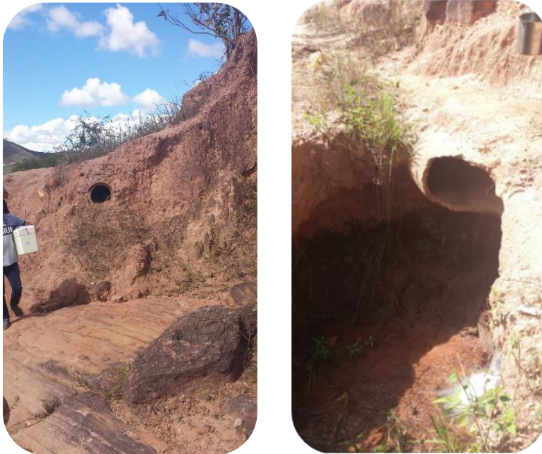
Figura 903: Adutora do Córrego Santaninha da COPASA.
