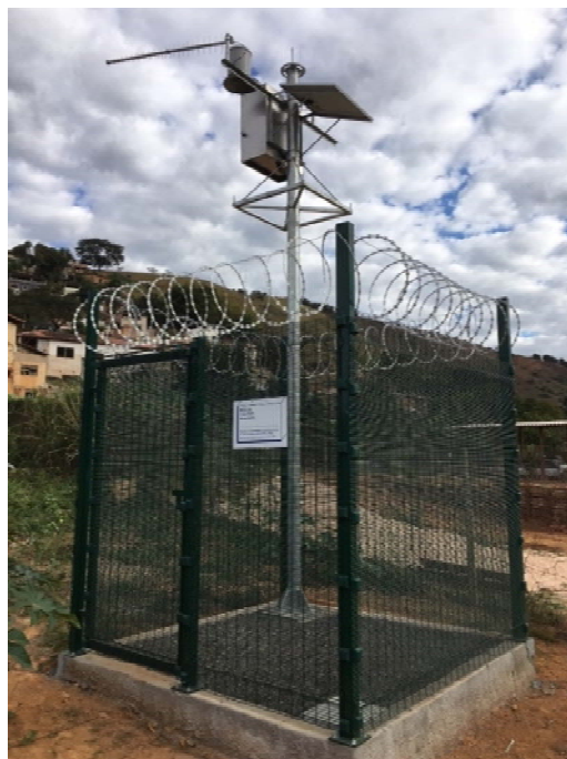
Figura 3.7: Foto de uma estação automática TIPO II instalada em Barra Longa (RCA02).
