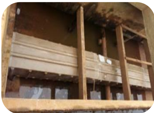
Figura 14: Difusor instalado em decantador da ETA Central.
