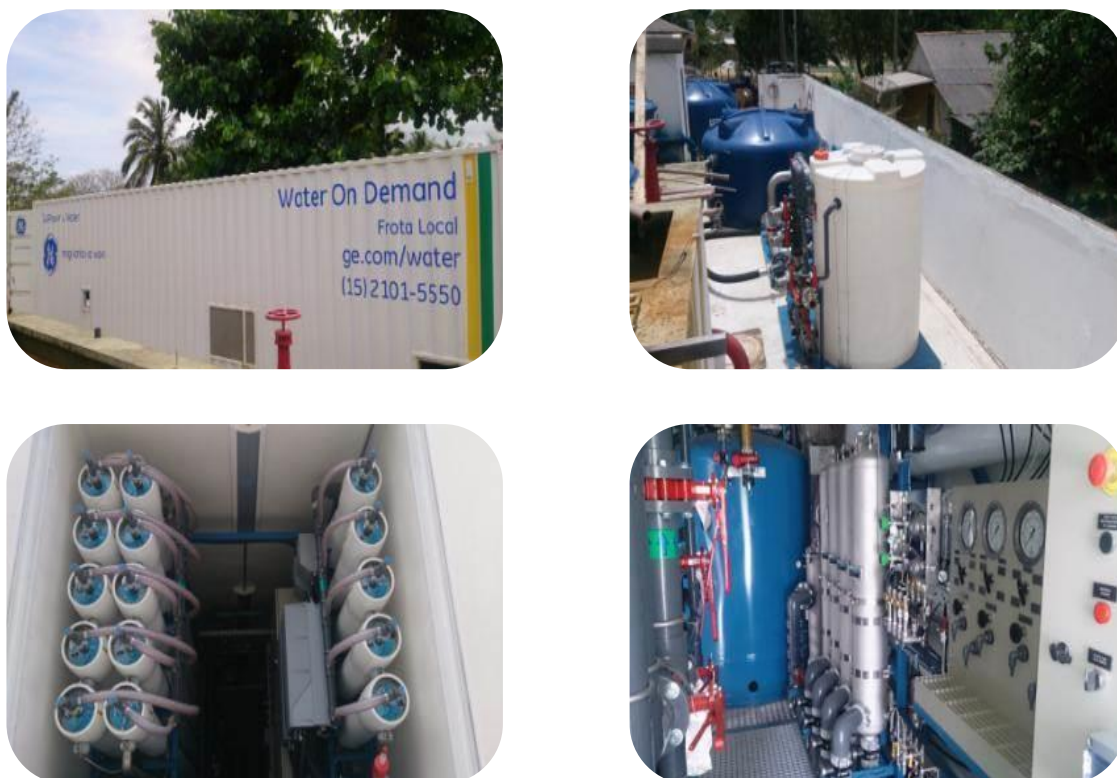
Figura 64: Imagens da Estação de Tratamento Móvel.
