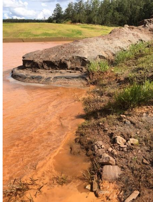
Material inconsolidado presente na Barragem Nova Santarém
