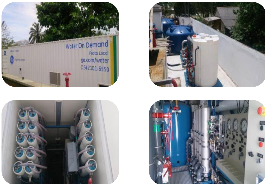
Figura 64: Imagens da Estação de Tratamento Móvel.
