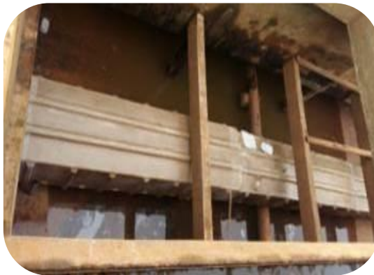
Figura 14: Difusor instalado em decantador da ETA Central.
