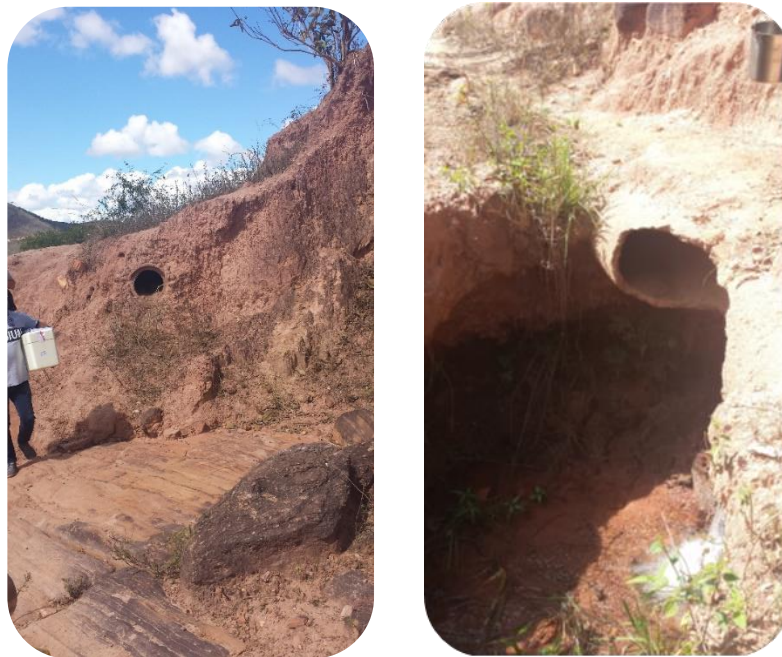
Figura 933: Adutora do Córrego Santaninha da COPASA.
