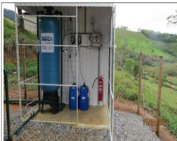
Figura 35 - Sistema de tratamento de água completo: Filtro, pintura da tubulação, bombonas com produtos químicos, bombas dosadoras, quadro de comando etc.
