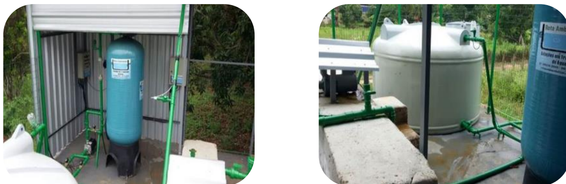
Figura 31: Imagem do filtro (à esquerda) e do reservatório (à direita) do sistema de tratamento da água do poço do distrito de São Tomé do Rio Doce.
