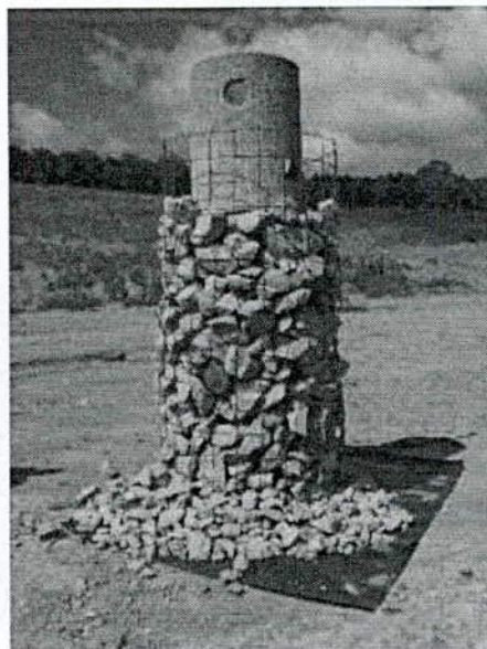
Foto 5.71 – Dreno de biogás do aterro sanitário
