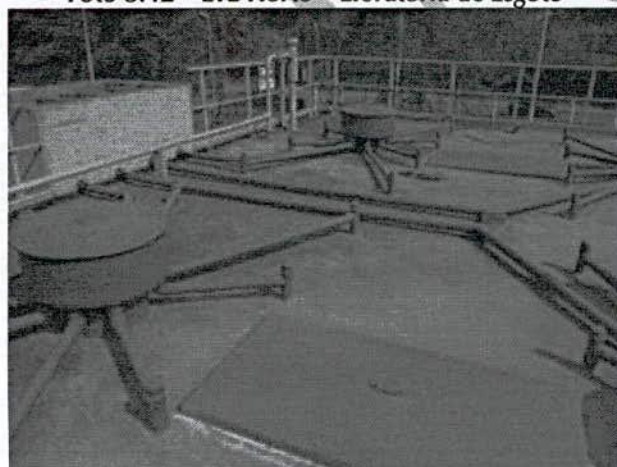
Foto 5.44 - ETE Horto - Reator UASB
