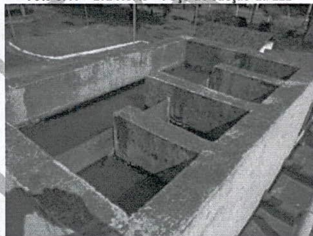
Foto 5.43 - ETE Horto - Caixa de Distribuição de Vazão
