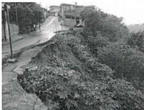
Foto 5.100 – Erosão próxima a casas, comprometendo já parte da rua (Bairro Vale do Sol)
