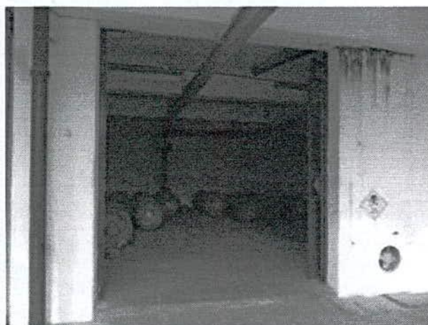
Foto 5.8 – ETA Amaro Lanari – Armazenamento de Cloro em Gás
