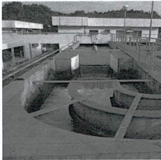
Foto 5.4 – ETA Amaro Lanari – Chegada da Água Bruta – Calha Parshall e Redutor de Velocidade
