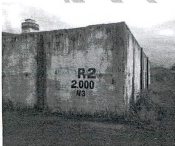
Foto 5.11 – Complexo de Reservação – R.2
