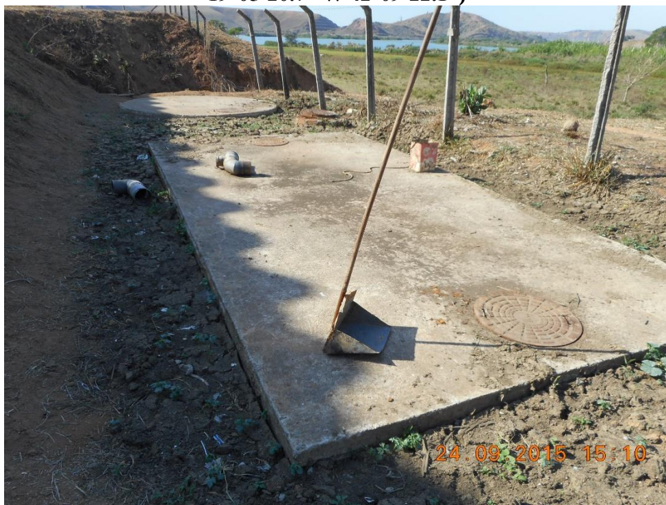
Figura 46: Estação de Tratamento de Esgoto do distrito de Pedra Corrida (Local: S 19°05'20.7" W 42°09'22.1")
