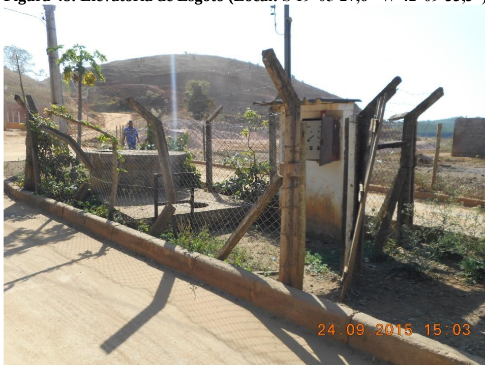
Figura 48: Elevatória de Esgoto (Local: S 19°05'27,6" W 42°09'33,3")
