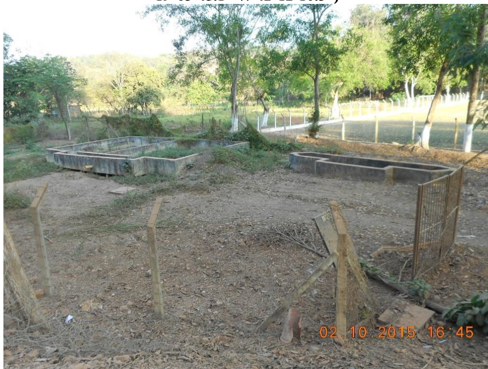
Figura 52: Estação de Tratamento de Esgoto do Comunidade de Serraria (Local: S 19°03'45.1" W 42°12'10.3")
