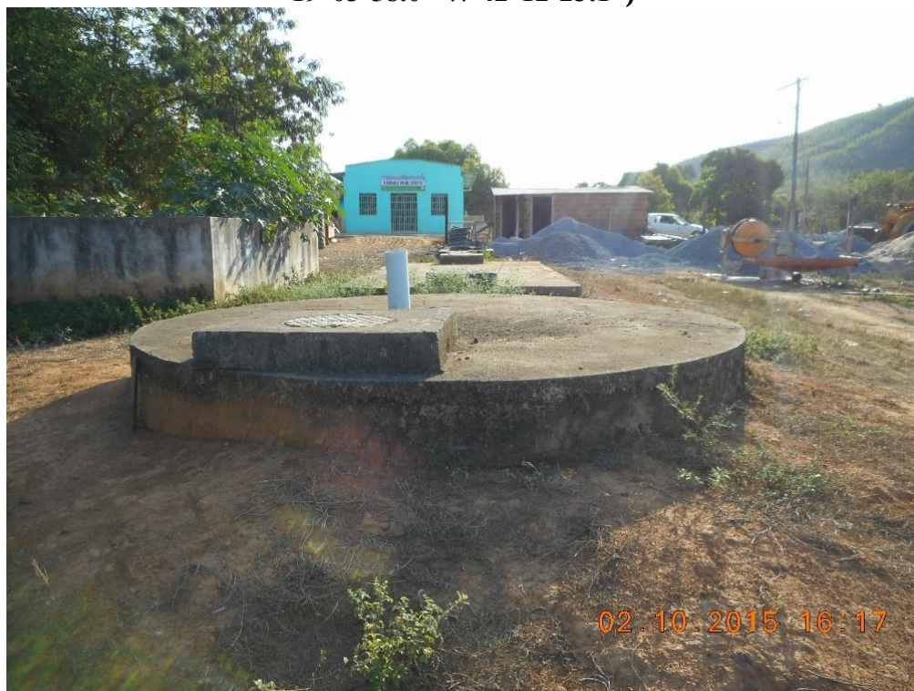
Figura 51: Estação de Tratamento de Esgoto do Comunidade de Serraria (Local: S 19°03'58.0" W 42°12'23.1")
