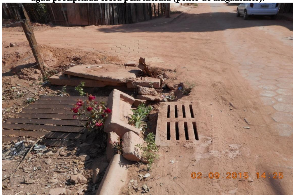
Figura 63: Rua no município de Periquito com drenagem (ineficiente) pluvial onde água precipitada escoar pela mesma (ponto de alagamento).
