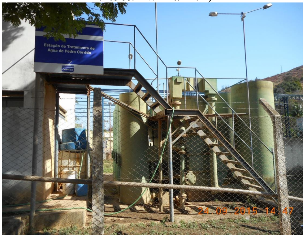
Figura 36: Estação de Tratamento de água no Distrito de Pedra Corrida (Local: S 19°05'35.2" W 42°09'24.1")
