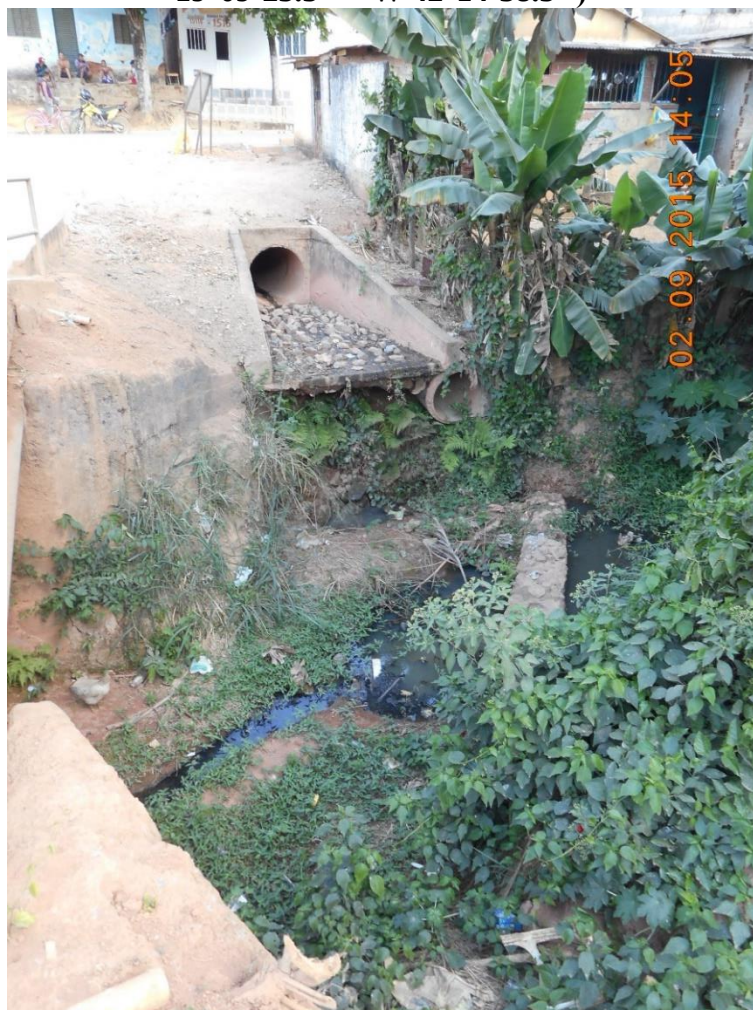
Figura 43: Ponto final da rede de esgoto na sede do município de Periquito (Local: S 19°09'25.5'' – W 42°14'38.5'')
