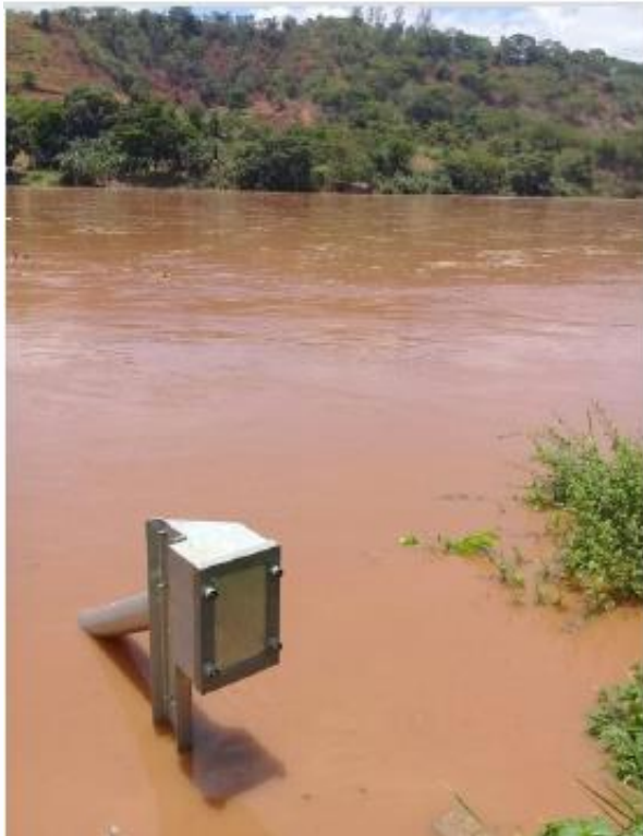
Caixa de acesso a sonda parcialmente submersa no dia 05/12
