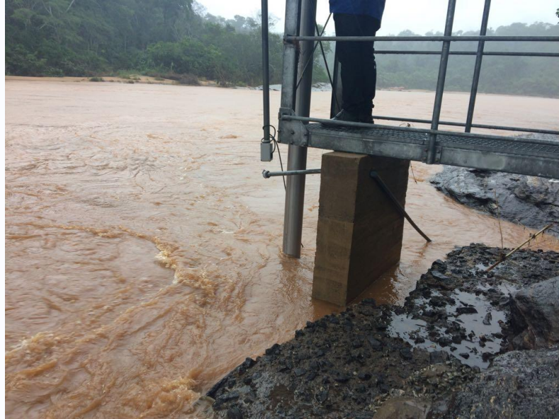
Estrutura dos cabos danificada em 11/12
