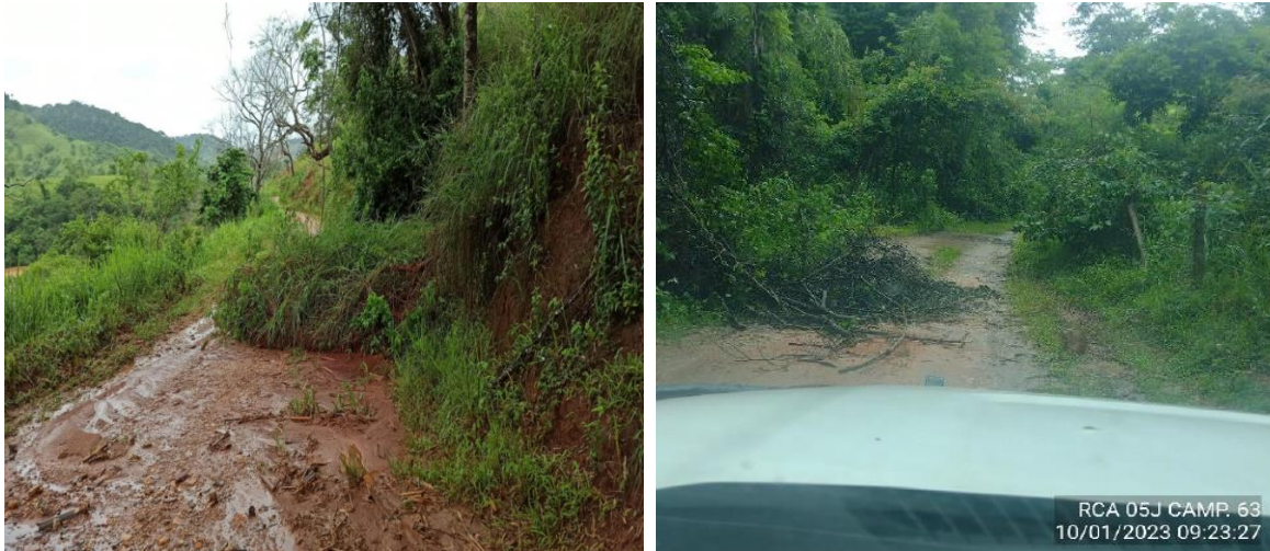
Figura 1 – Condições da estrada de acesso ao RCA 05J (10/01/2023).
