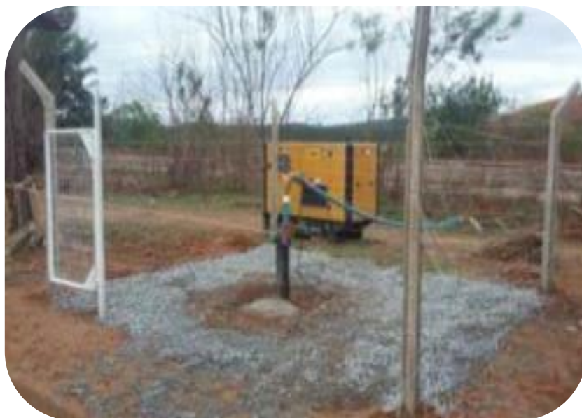
Figura 76: Poço 03 de Belo Oriente, considerado para abastecimento emergencial.
