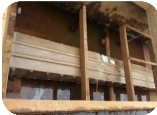
Figura 14: Difusor instalado em decantador da ETA Central.
