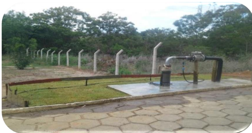
Figura 102. Imagem do poço de Mascarenhas interligado a ETA do distrito.
