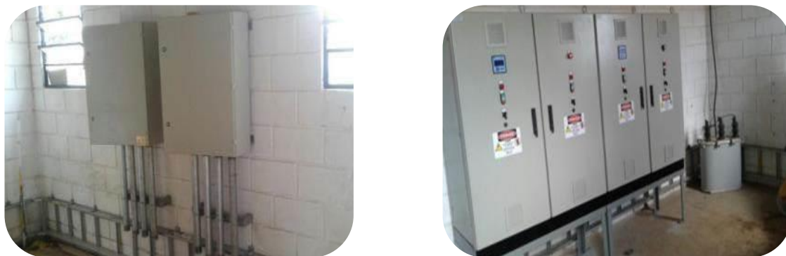
Figura 5: Evidência de melhoria do sistema elétrico, após a instalação de painéis com inversores de frequência.
