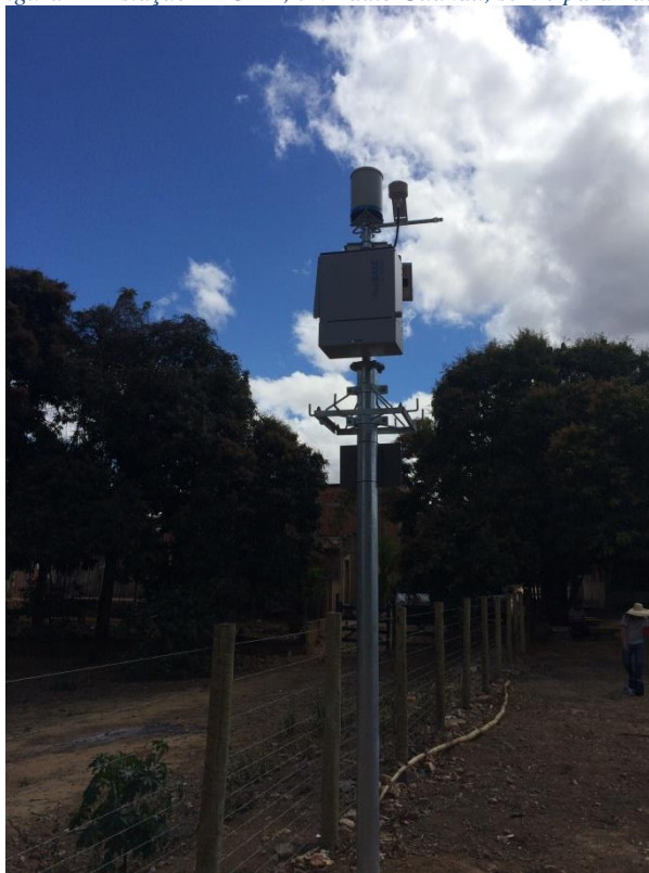
Figura 1 - Estação RDO-11, em Baixo Guandu, sem o para-raio.
