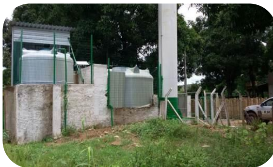
Figura 30: Área de sistema de captação por poço, que teve ação de melhoria.
