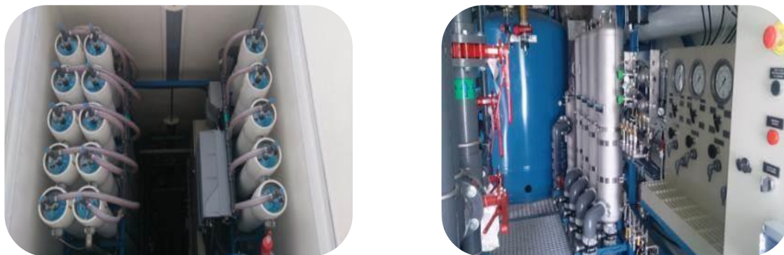
Figura 64: Imagens da Estação de Tratamento Móvel.
