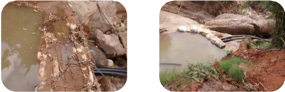
Figura 90: evidências de captação no córrego Santaninha.
