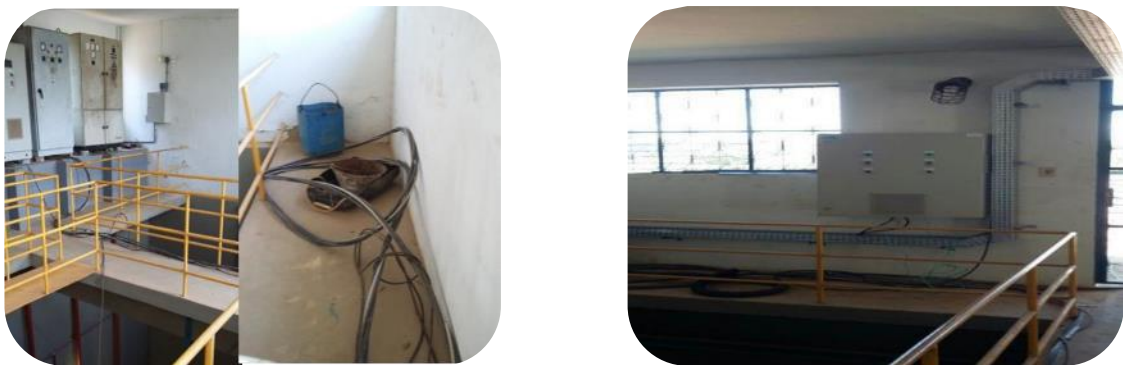
Figura 42: Novo painel (à esquerda) e eletrocalha (à direita) instalados na ETA 1 de Colatina.
