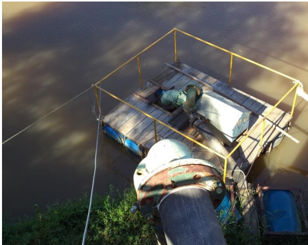
FIGURA 5 – CAPTAÇÃO (VISTA 1) (FONTE: ACERVO DO AUTOR, 2014)
