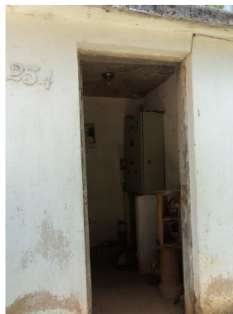
FIGURA 23 – POÇO TUBULAR JURUMIRIM (VISTA 2) (FONTE: ACERVO DO AUTOR, 2014)
