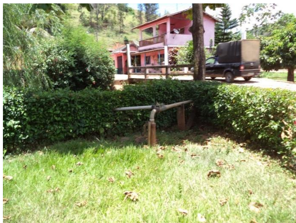
FIGURA 22 – POÇO TUBULAR JURUMIRIM (VISTA 1) (FONTE: ACERVO DO AUTOR, 2014)
