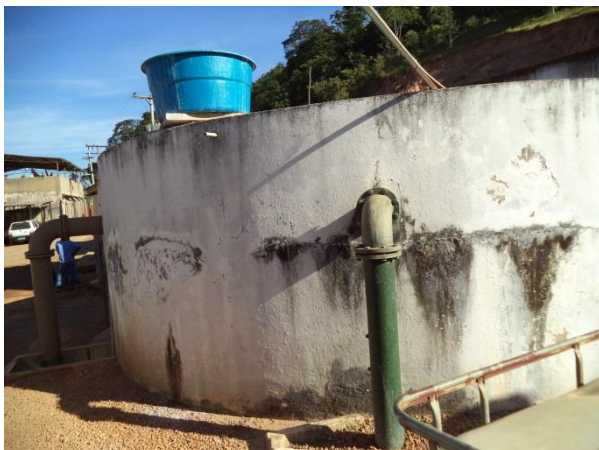
FIGURA 11 – ETA COMPACTA (VISTA 1) (FONTE: ACERVO DO AUTOR, 2014)
