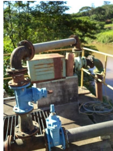
FIGURA 6 – CAPTAÇÃO (VISTA 2) (FONTE: ACERVO DO AUTOR, 2014)
