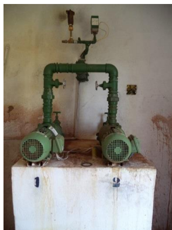
FIGURA 19 – BOMBAS DA EEAT3 (FONTE: ACERVO DO AUTOR, 2014)
