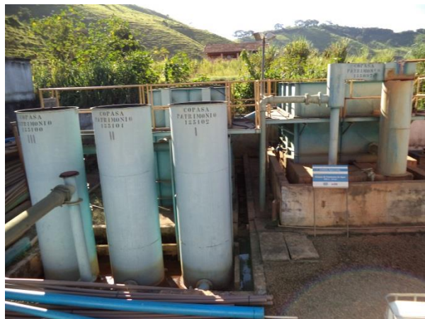
FIGURA 12 – ETA COMPACTA (VISTA 2) (FONTE: ACERVO DO AUTOR, 2014)
