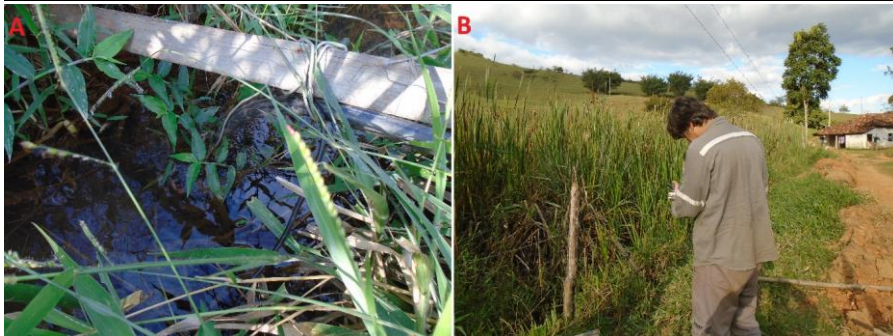
Foto 6.11: Ponto SCA-US-01. A) Local da captação, bomba submersa conectada a adutora de 1". B) Ambiente onde ocorre a captação e residência dos usuários.
