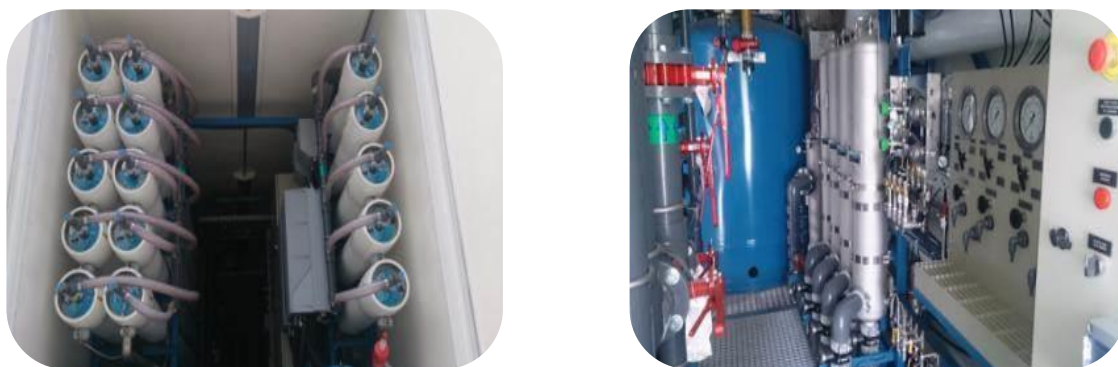
Figura 64: Imagens da Estação de Tratamento Móvel.
