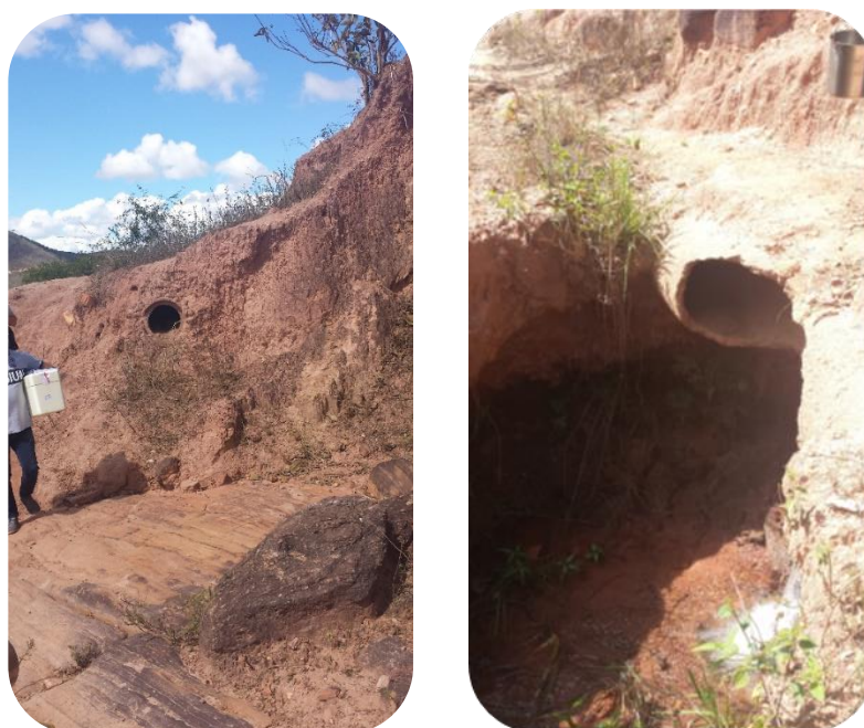
Figura 933: Adutora do Córrego Santaninha da COPASA.
