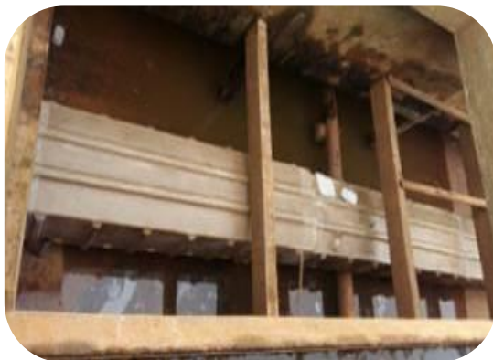
Figura 14: Difusor instalado em decantador da ETA Central.
