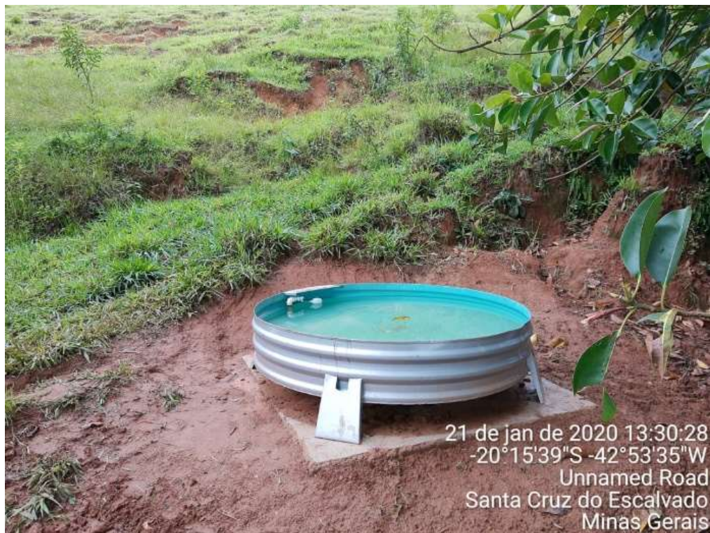
Instalação de bebedouros, retirando o acesso do gado dos tributários e do rio – propriedade de Flávio Mota em Santa Cruz do Escalvado/MG - 21/02/2021
