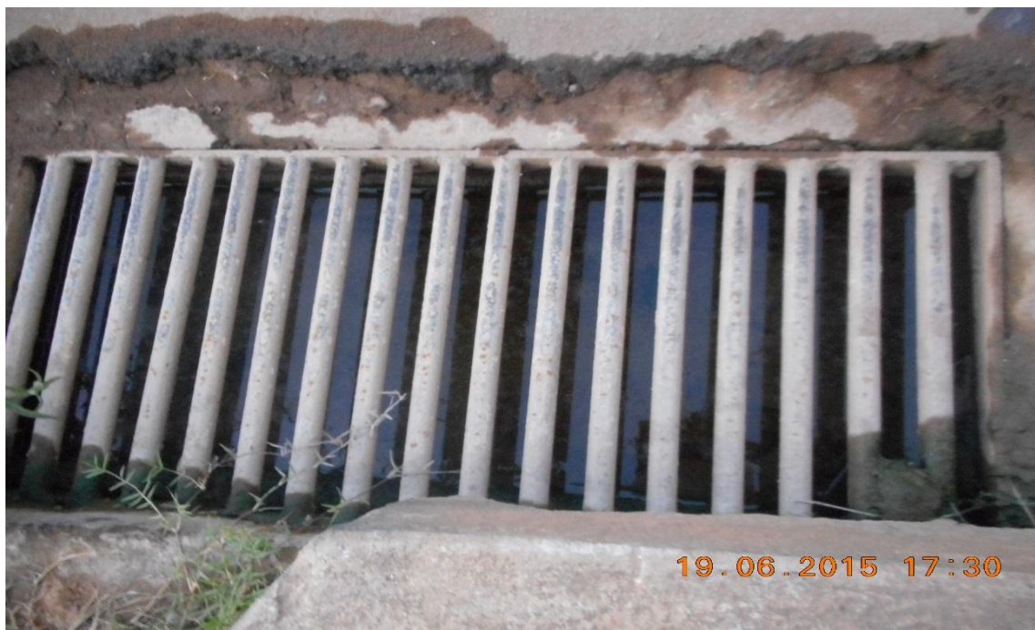
Figura 61: Resultado do carreamento de sedimentos para a rede drenagem (Bueiro entupido com esgoto ligado a rede pluvial)
