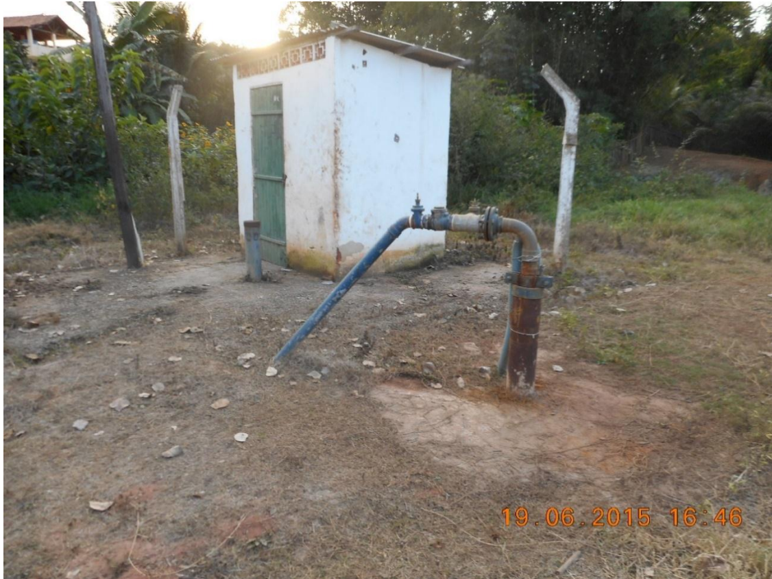
Figura 32: Ponto de captação de água para abastecimento público, Poço Artesiano (Local: S19°25'16,8'' W42°15'22,3'' altitude: 370 )
