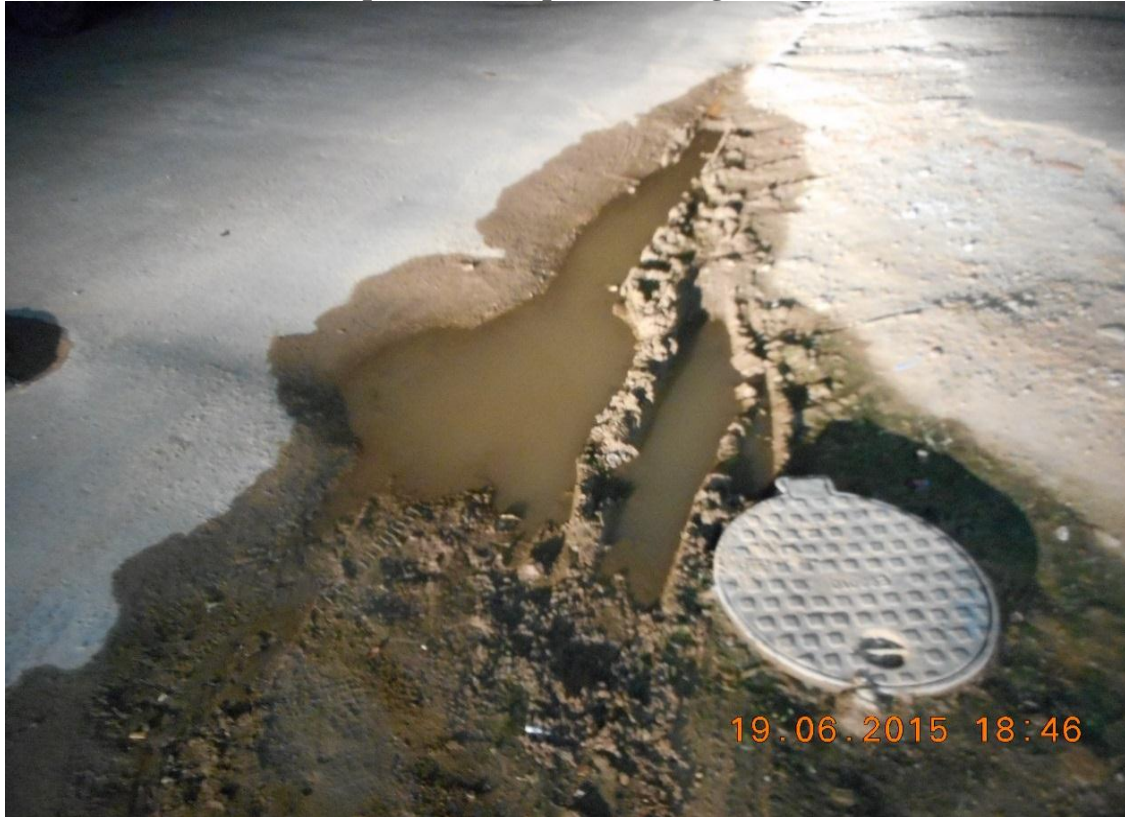
Figura 59: Rua na cidade de Bugre sem drenagem pluvial onde toda água precipitada escoou pela mesma (ponto de alagamento).
