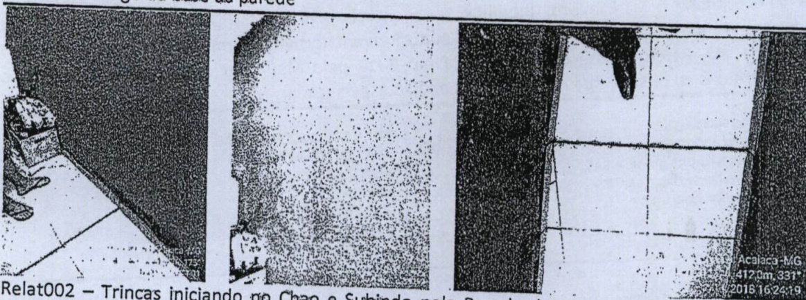
Relat001 – Trincas na Residência todo a extensão da entrada da casa já na sala no primeiro andar percebe – se as trincas ao longo da base da parede
