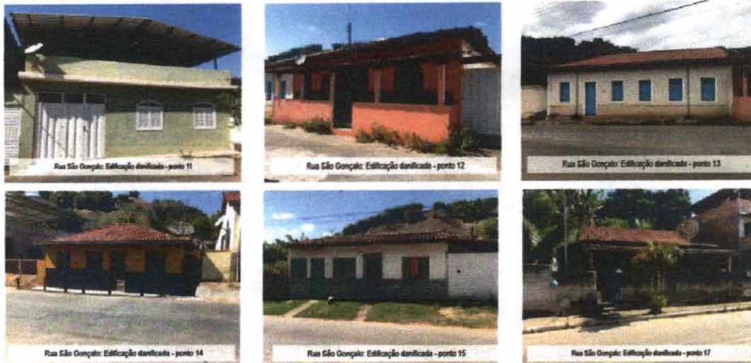
Figura 7 - Edificações danificadas localizadas na Rua São Gonçalo (Figura 5 do anexo)
