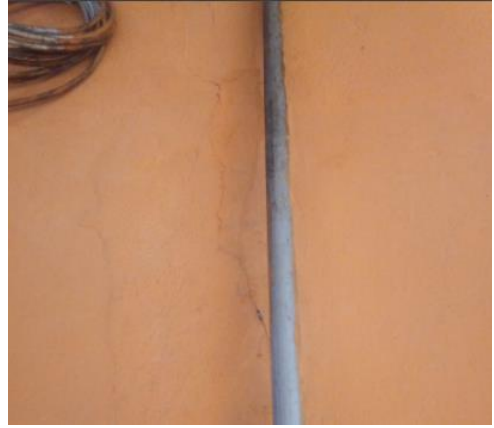
Trinca nas casas
