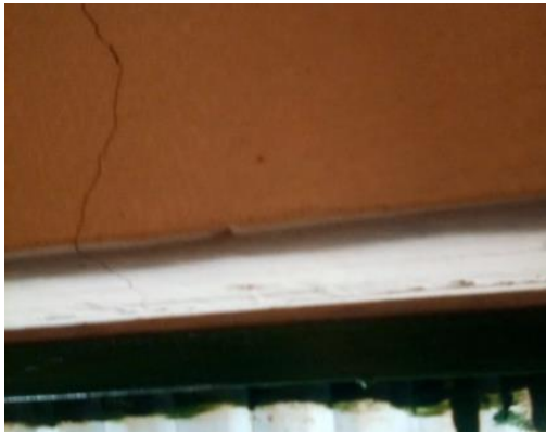
Trinca nas casas
