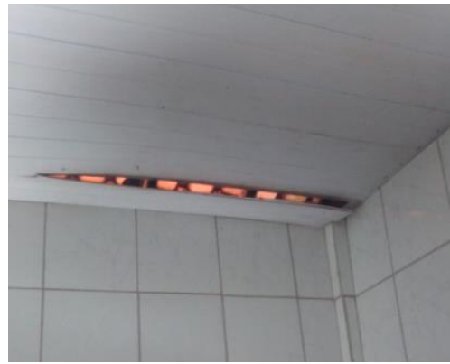
Trinca nas casas
