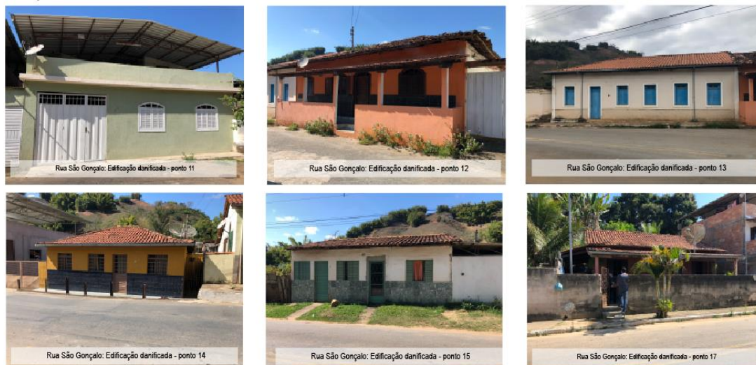
Figura 7 - Edificações danificadas localizadas na Rua São Gonçalo (Figura 5 do anexo)
