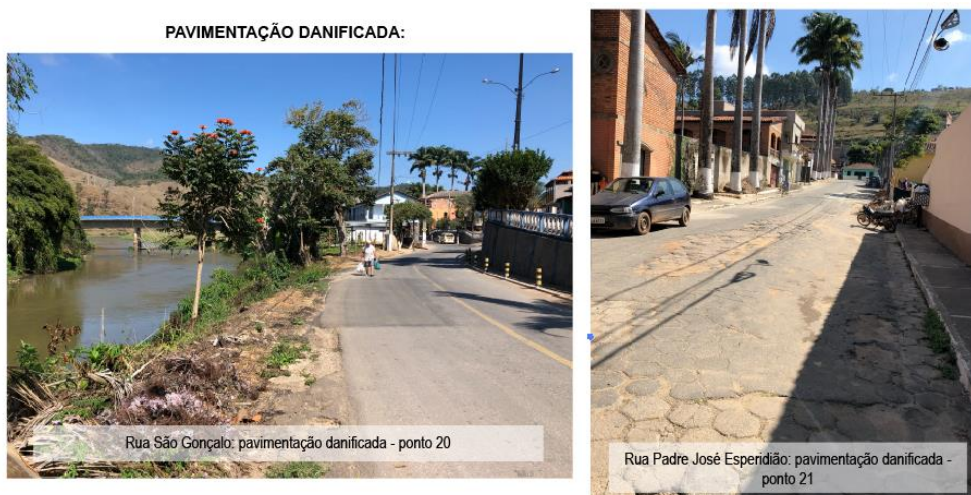
Figura 8 – Pavimentação danificada na Rua São Gonçalo e na Rua Padre José Esperidião (Figura 6 do anexo)
