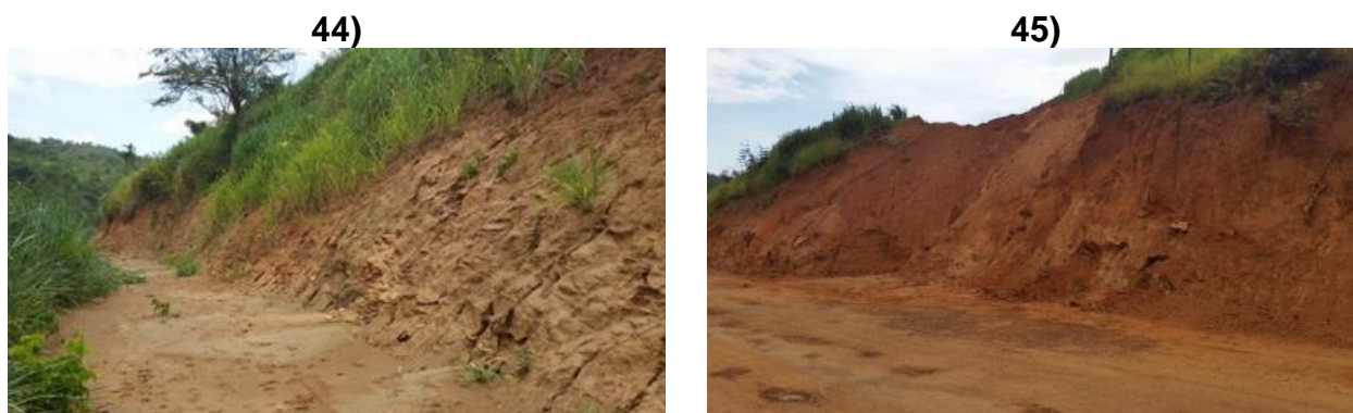
Figura 20 - Encosta cadastrada nos pontos 44 e 45
