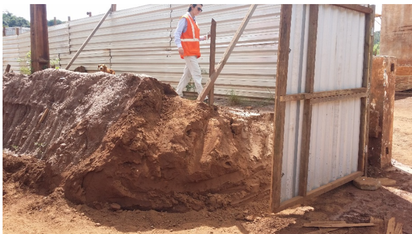
Foto 8-37. Depósito de material detrítico junto à Capela de Santo Antônio, com cerca de 1 m de espessura.
