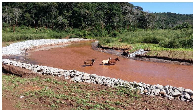
Foto 8-24. Trecho 8, com obras de estabilização de margens. Notar alta turbidez das águas e pequena profundidade da lâmina d'água.
