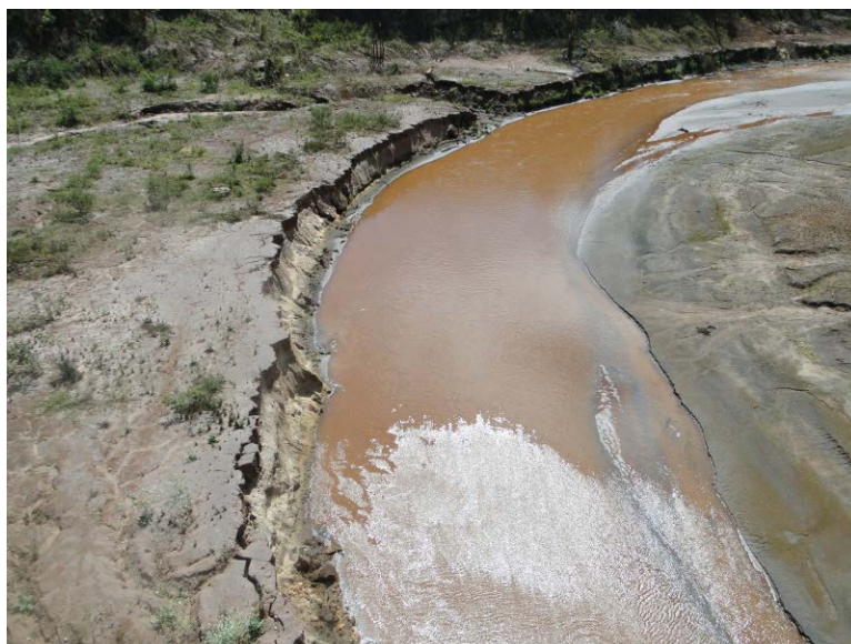
Foto 8-39. Solapamento de margem em camada de sedimentos aluvionares arenosos na parte externa da curva do rio Gualaxo
