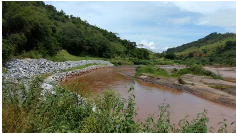
Foto 3-3. Enrocamento na margem do rio Gualaxo do Norte nas proximidades de Gesteira. A calha fluvial marca aqui o limite da planície aluvial
