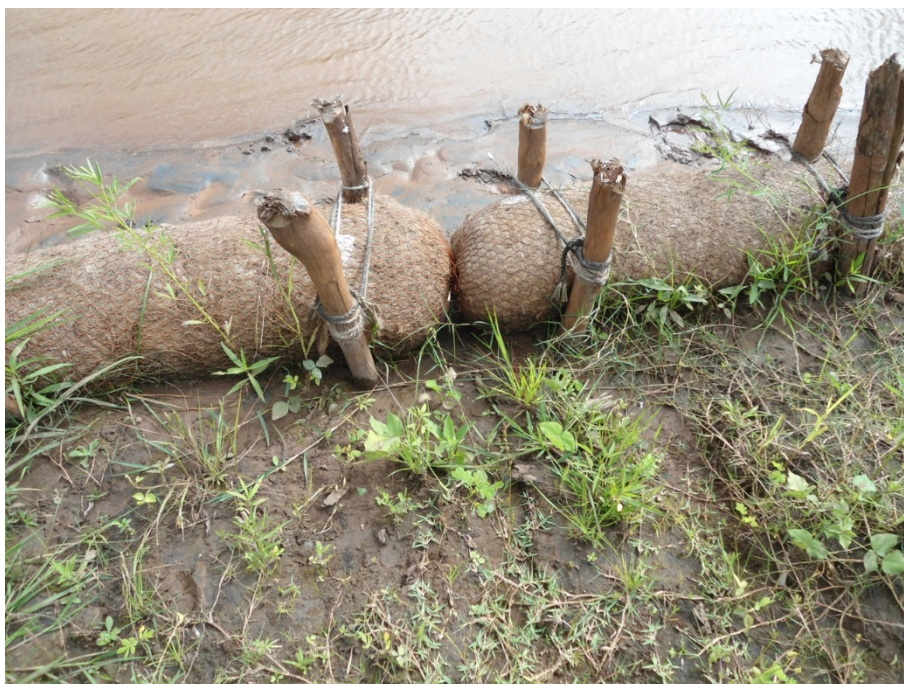
Figura 98. Ponto com fuga de material entre retentores de sedimentos
