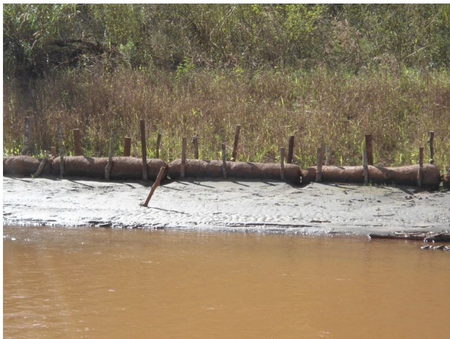
Figura 91. Pontos de discontinuidades entre elementos de retenção
