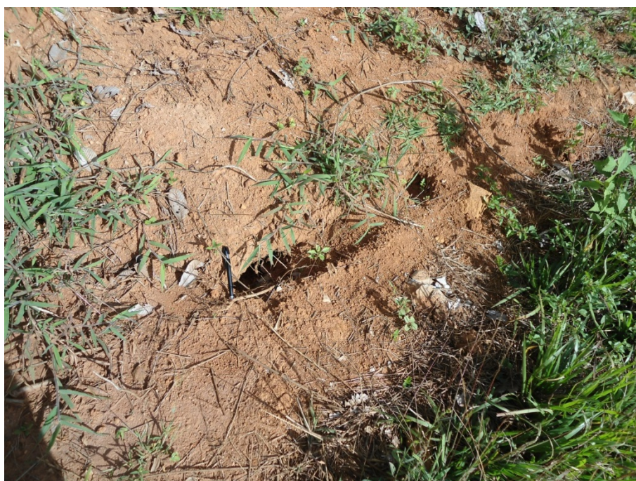
Figura 104. Vista de outro ponto da trinca com uma caneta como referência de escala
