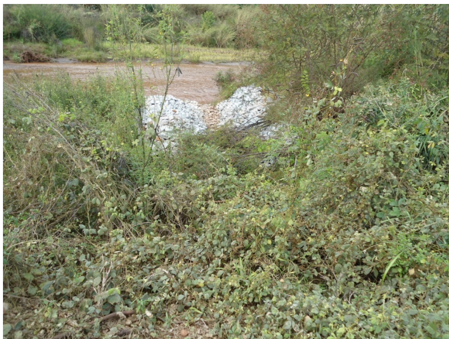
Figura 88. Detalhe da vegetação desenvolvida na calha junto, à saída de enrocamento
