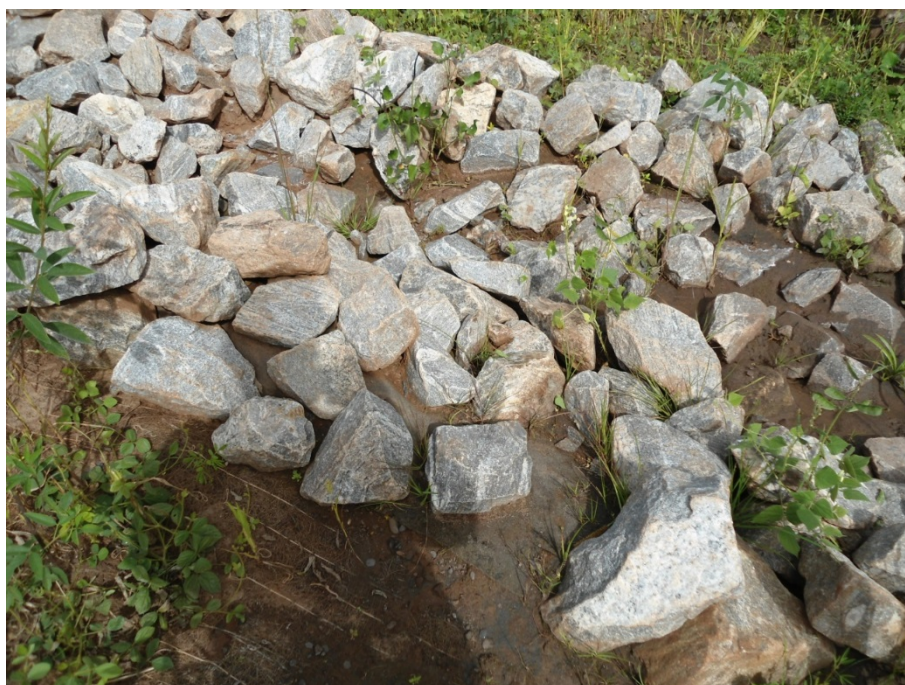
Figura 100. Detalhe da falta de cobertura de rocha na descida de água
