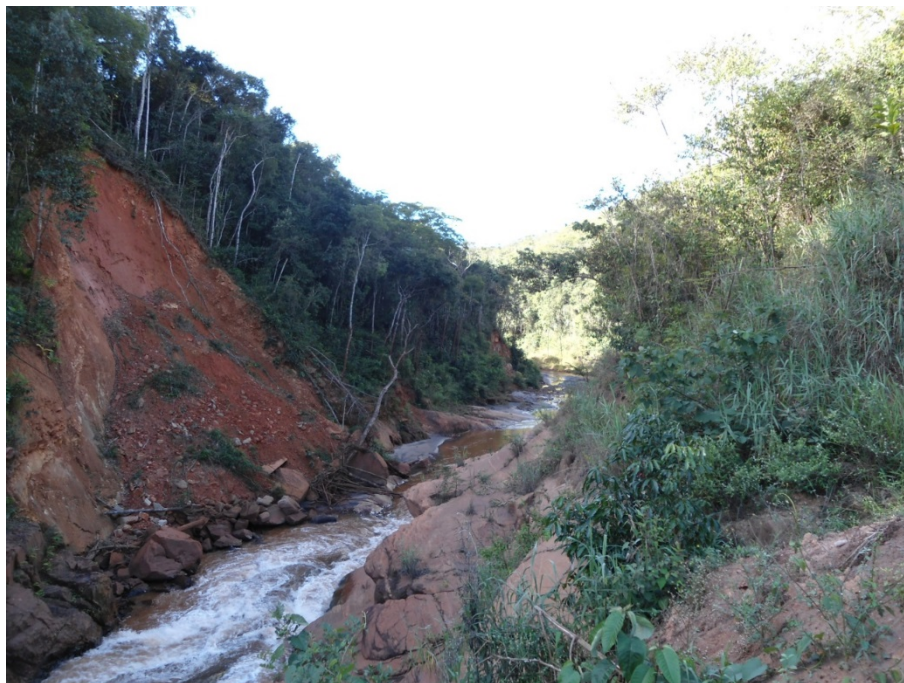
Figura 116. Ruptura de talude no Trecho 8
