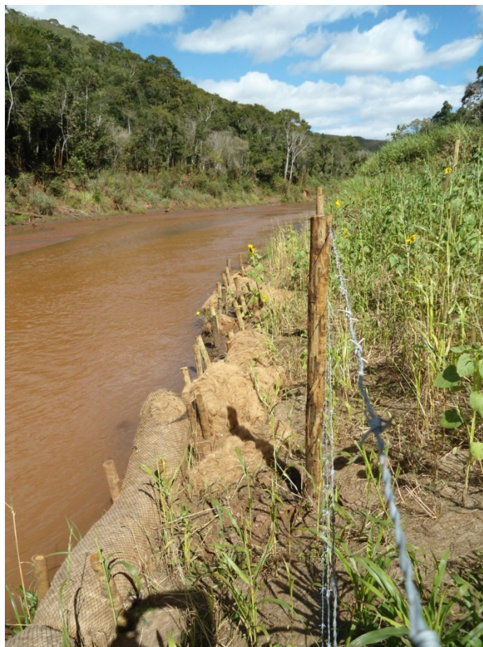
Figura 113. Retentores de sedimento danificados junto a margem esquerda do rio
