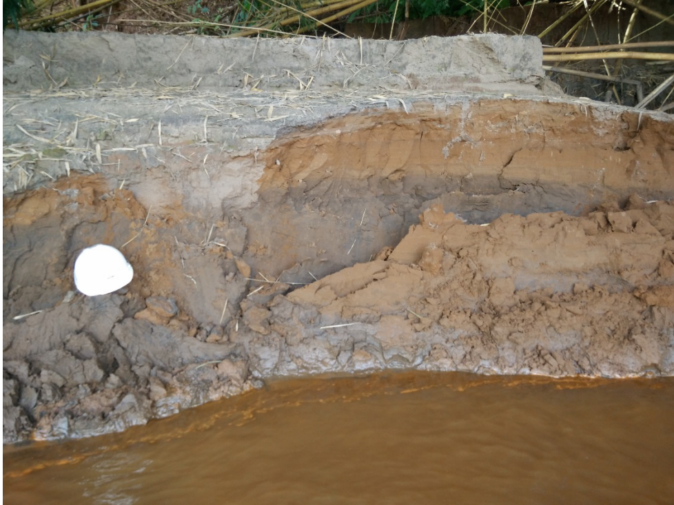
Foto 16: Margem em processo de erosão encontrado no PV-15, com exposição do rejeito inconsolidado.
