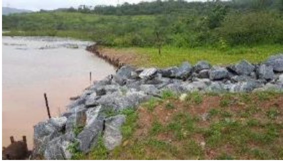
Ponto de desague do canal finalizado com enrocamento e revegetação das margens.
