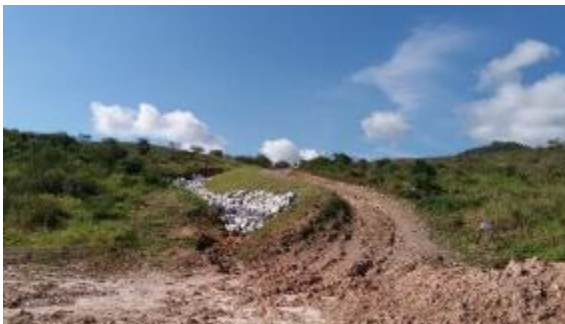
Canal de drenagem inacabado e acesso erodido (antes das intervenções). Fonte: GOLDER
