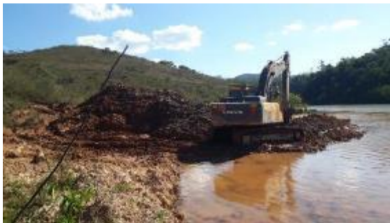
Remoção de sedimentos aportados no lago provenientes do acesso e da canaleta inacabada.
