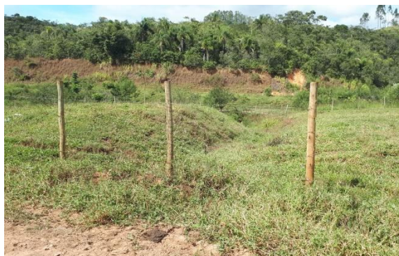
Execução de canal de drenagem e proteção da área com plantio de mix de sementes
