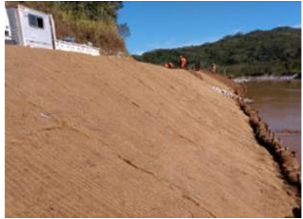
Instalação de descidas d'água e proteção de talude com mix de cimentos
