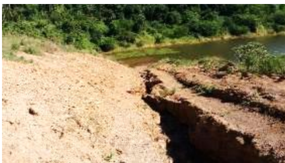
Processo erosivo instalado em canaleta não revestida.
