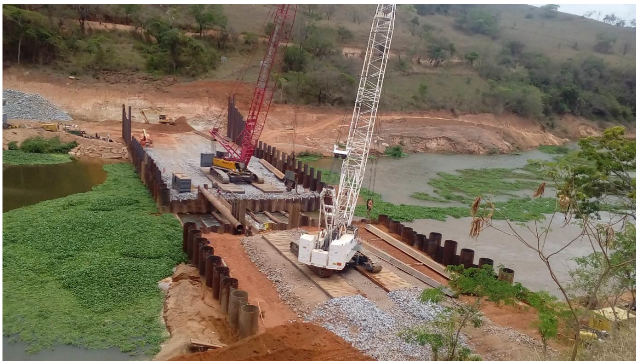
Foto 4 – Barramento C, em execução.
