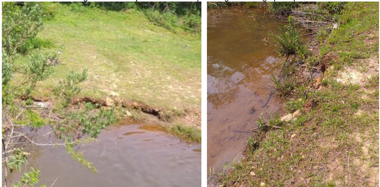
Figura 4 – Situação dos taludes que margeiam o lago principal
