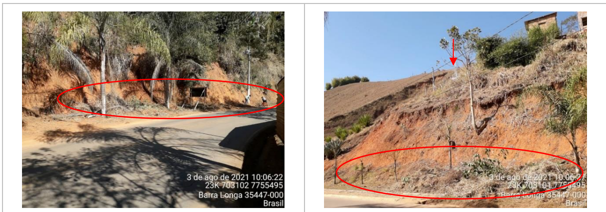
Figura A.2 - Limpeza e capina da vegetação no portal de Barra Longa próximo à estação Volta da Capela
