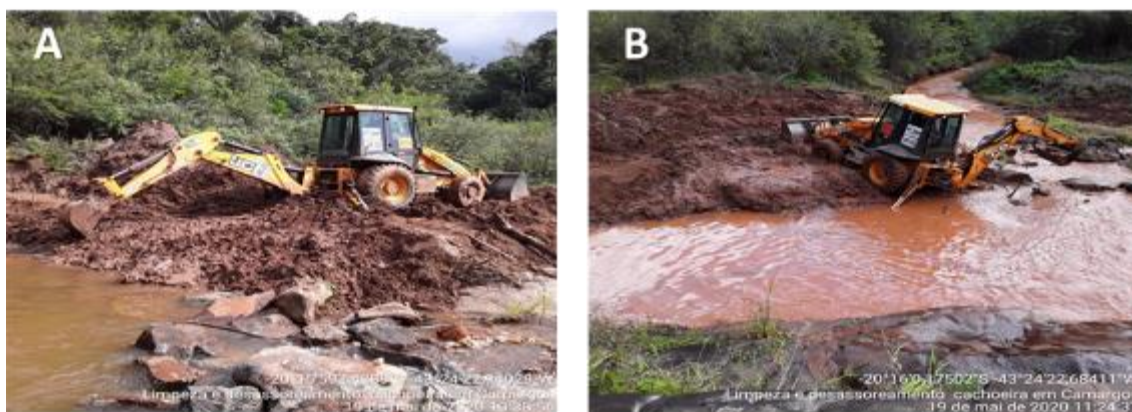
Figura 4.14: Retirada do rejeito da cachoeira e recomposição do fundo do lago (Fonte: Fundação Renova, 2020a)
