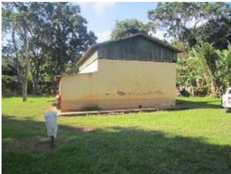
Figura 4-22: Marca de enchente em uma casa próxima ao canal
