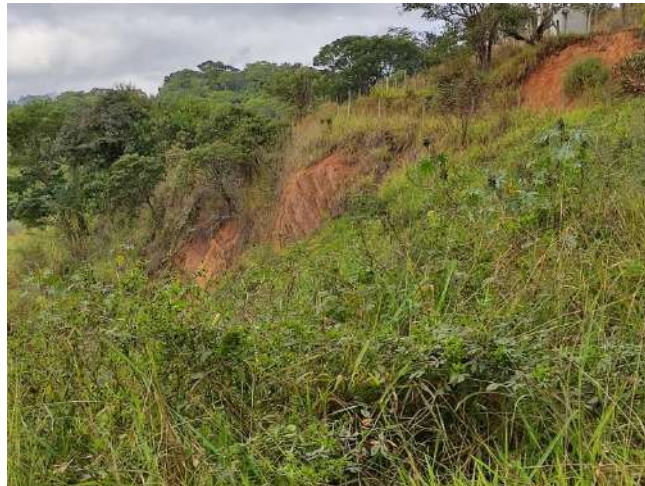
Foto 48: Talude com processo erosivo
