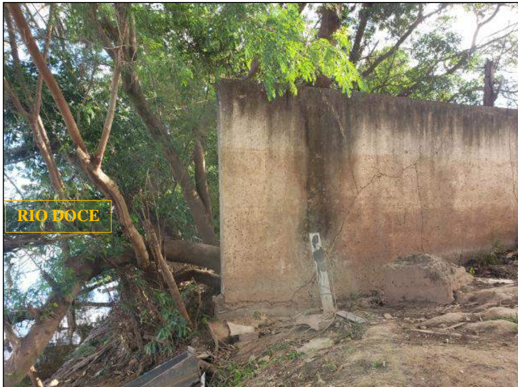
Figura 4-13 – Marca da cheia no muro.
