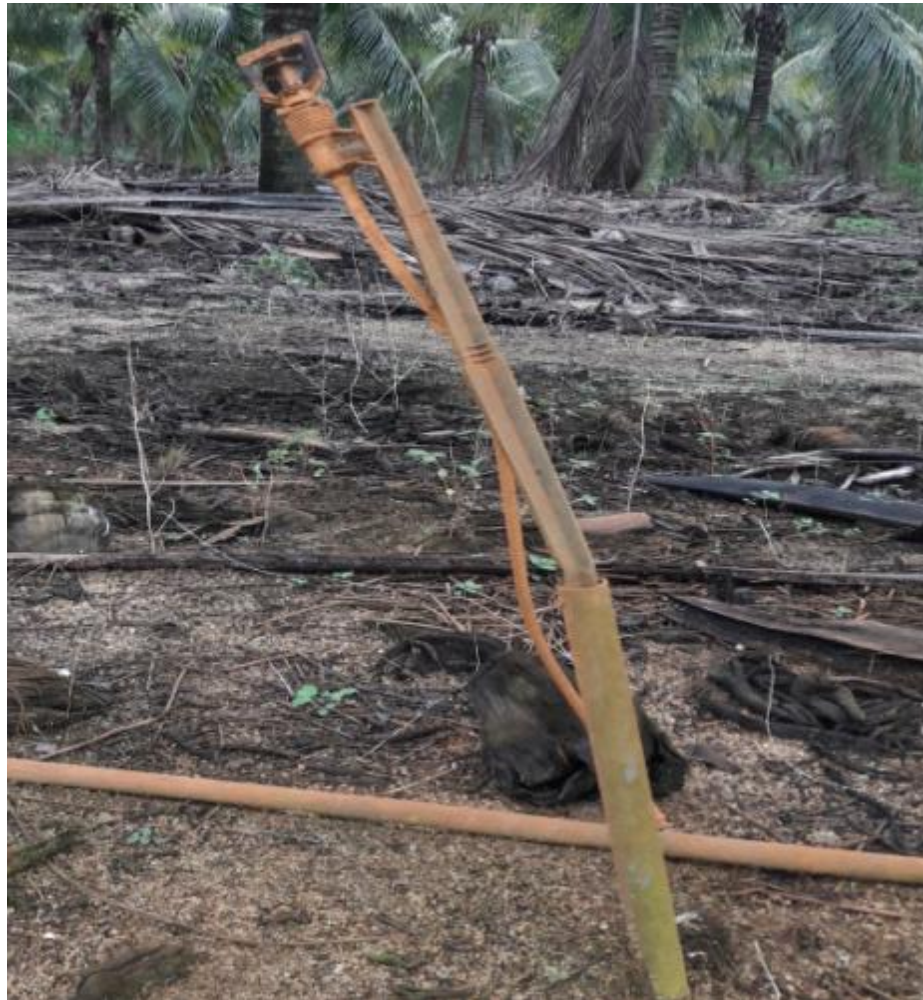
Imagem 112: Sistema interrompido por desgaste de peça giratória de distribuição de água
