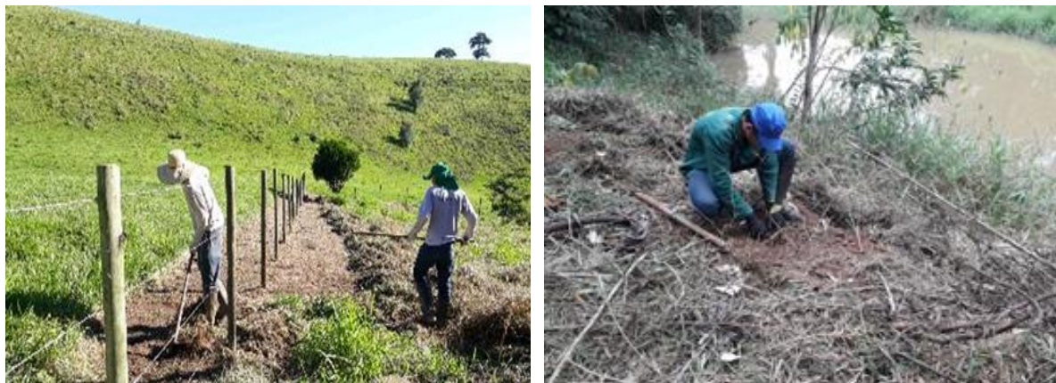
Figura 6- Atividades de recuperação de APPs, recarga hídrica e nascentes desenvolvidas pelos PGs 26 e 27.
