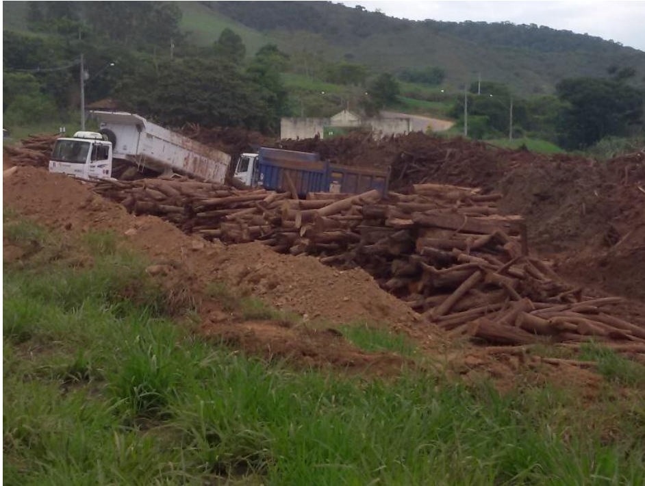
Figura 4 – Pilha de material lenhoso segregado
