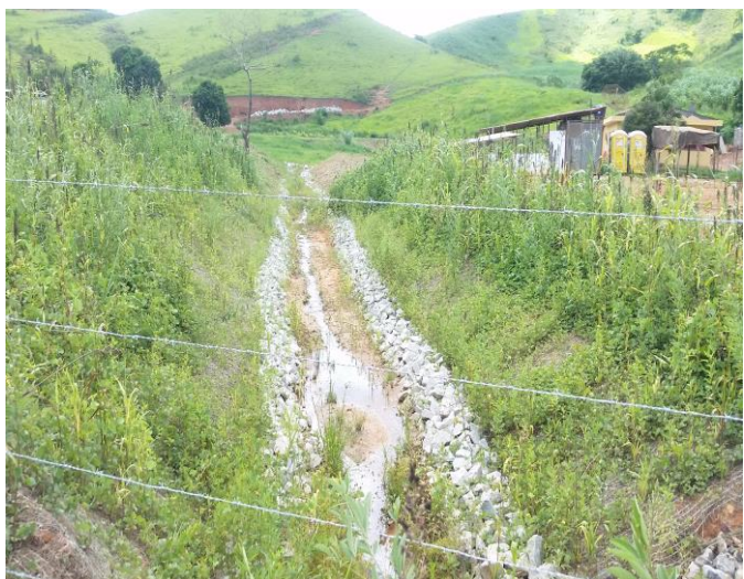
Imagem 15- Aplicação de mix e enrocamento nos tributários, de acordo com projeto executivo.
