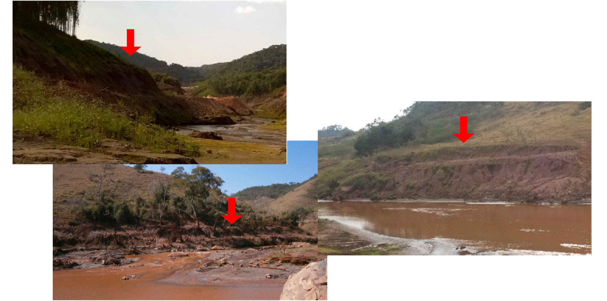
TIPO C - TALUDE ALTO EXPOSTO COM BERMA INTERMEDIÁRIA (SEM PRESENÇA DE PRAIA)
